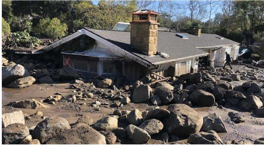
圖 1 土石流過後的現場情形。(圖源：SBCFD)
