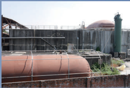
沼氣發電設施。
