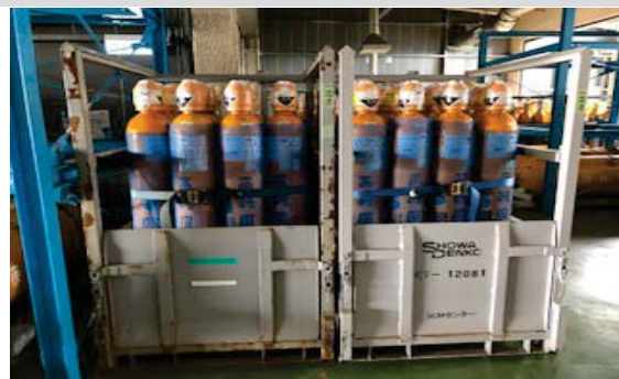
小鋼瓶置放欄子固定帶固定
