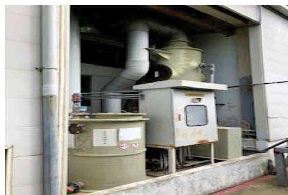
自動除害設備
