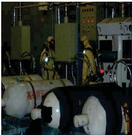
人員著防護衣確認洩漏
