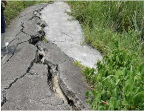
二寮-龜裂、崩壞的道路
