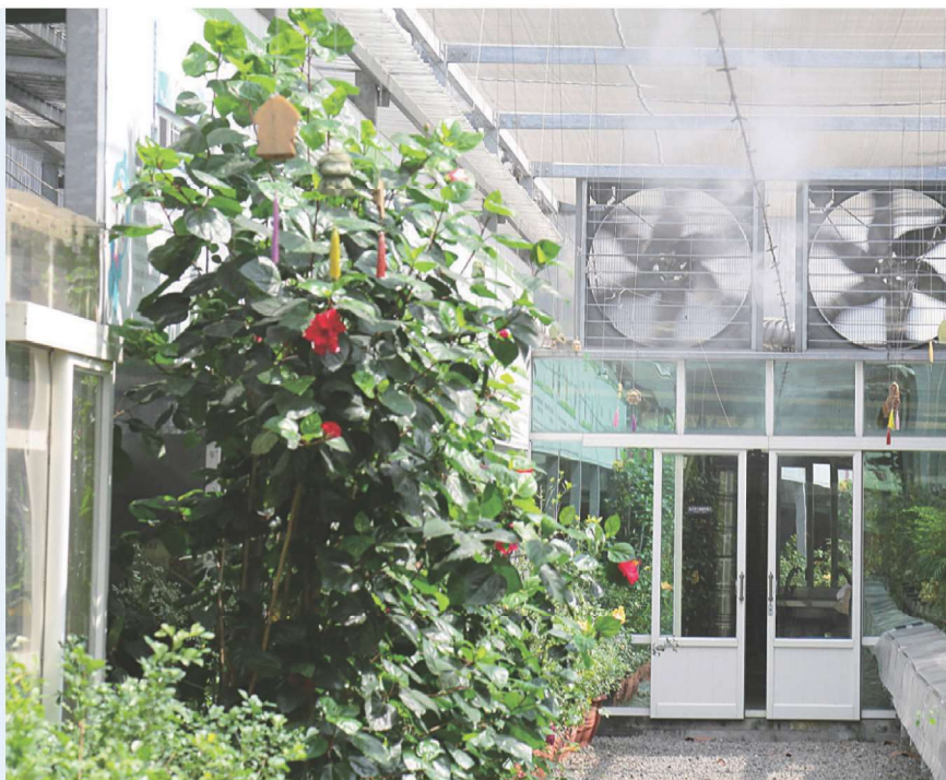
觀光工廠內的負壓冷風循環系統。
