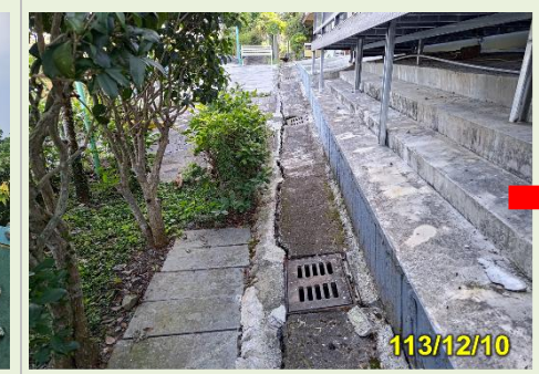
I 上邊坡社區內排水設施有開裂及陷落情形，新設排水設施持續產生破壞，現況裂縫寬度約 0.5~2cm
