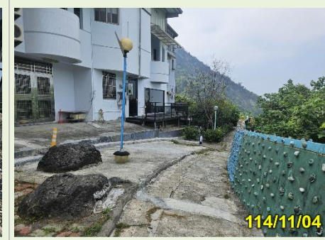
H 上邊坡社區地坪多處裂縫，且長期有下陷 1~2m 情形
