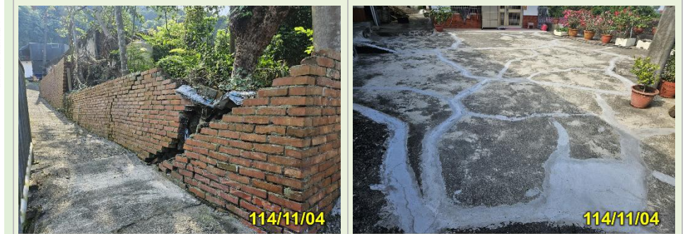
E 多處房舍圍牆及地坪開裂毀損，經修補持續破壞 F 住宅地坪有明顯陷落，裂縫寬度約 1cm，易造成地表水直接入滲
