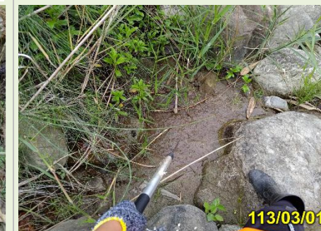
K 邊坡趾部多處有地下水出水現象，顯示邊坡地下水豐沛
