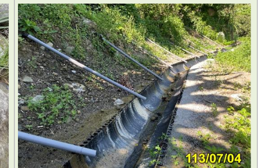
L 下邊坡新設坡面水平集水管明顯滲水，顯示地下水位豐沛或有受壓水層
