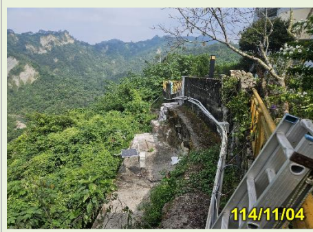
F 社區下邊坡補強工程，經噴漿面修補後持續有開裂情形
