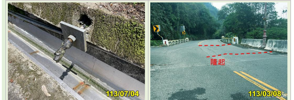
C 道路上邊坡地錨損壞情形，部分滲水情形嚴重 D 接近雲泉橋處，路面受地滑影響隆起、護欄錯移，下方部分地錨已斷裂
