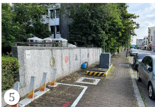
人行道僅高路面9公分，保護不足且設施物佔據
