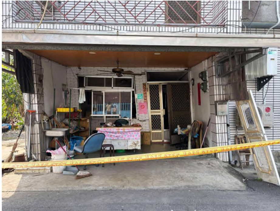
圖 34 2025 年初大地震導致楠西多處房產受損
