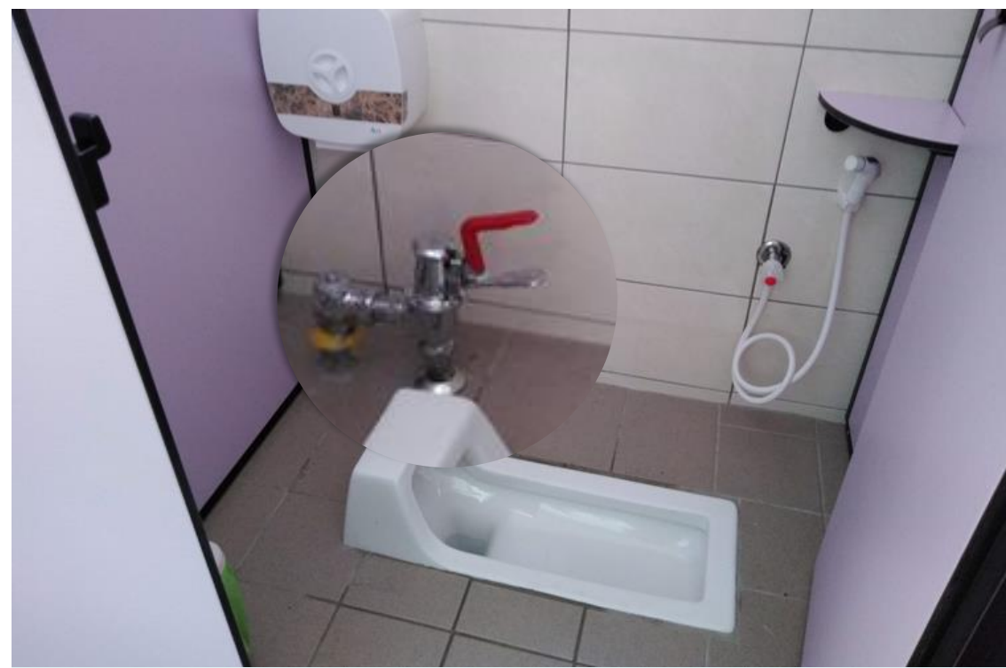
廁所裝置二段式沖水配件，沖水即可省一半水量
