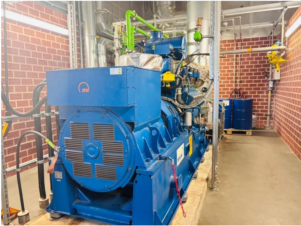
圖三、3-18.沼氣發電設備
