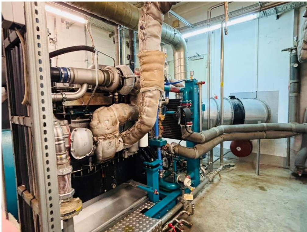
圖四、4-19.發電設備
