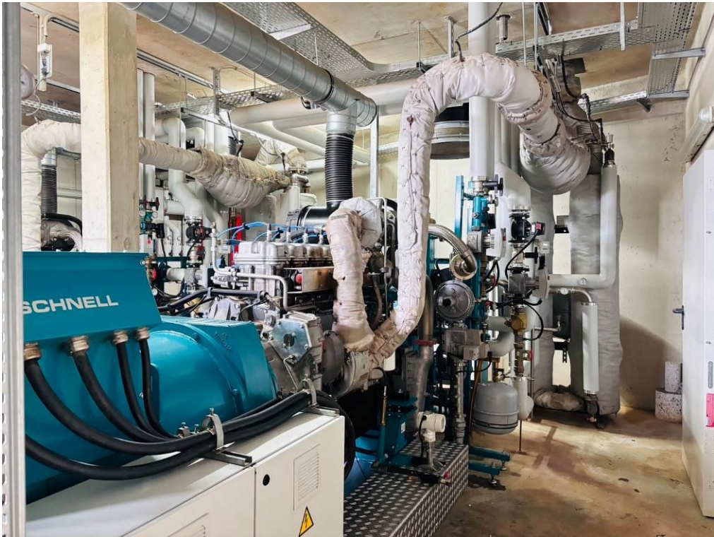
圖四、4-13. 發電設備
