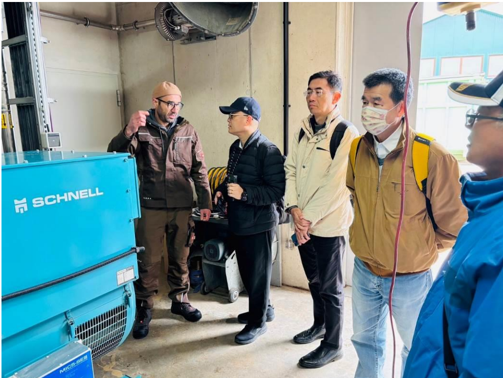
圖四、4-15.發電設備解說
