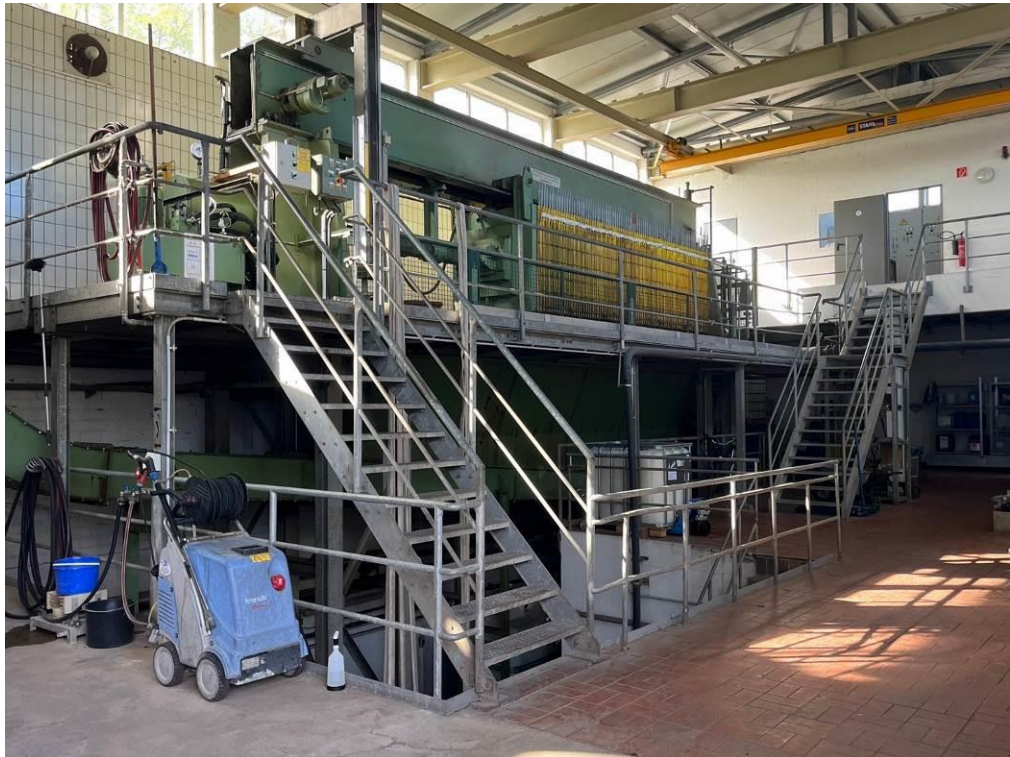
圖三、3-17.污泥處理設備
