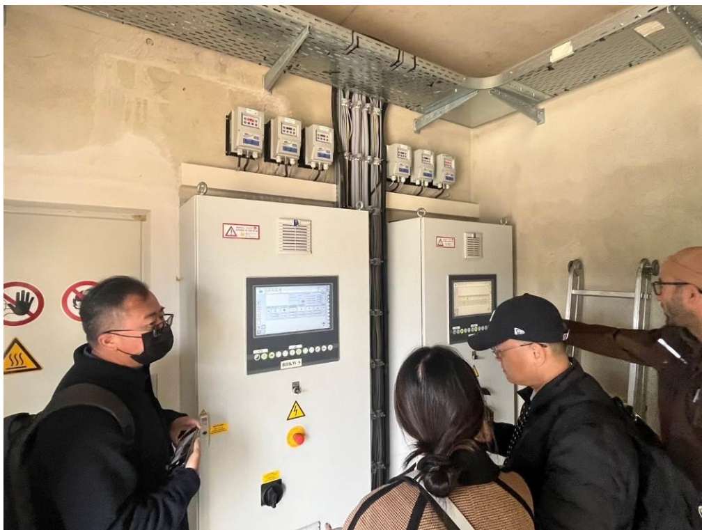
圖四、4-17.發電設備解說
