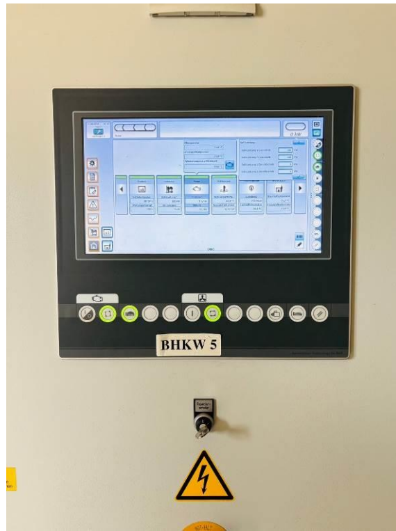
圖四、4-18.發電設備解說
