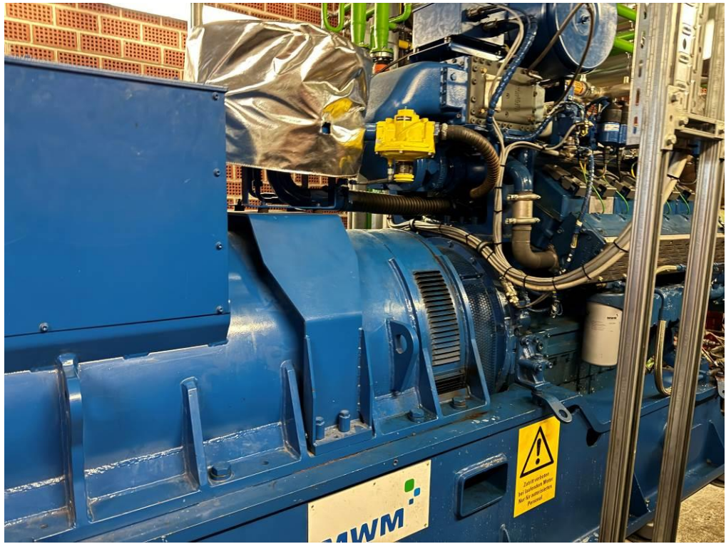
圖三、3-26.沼氣發電機組
