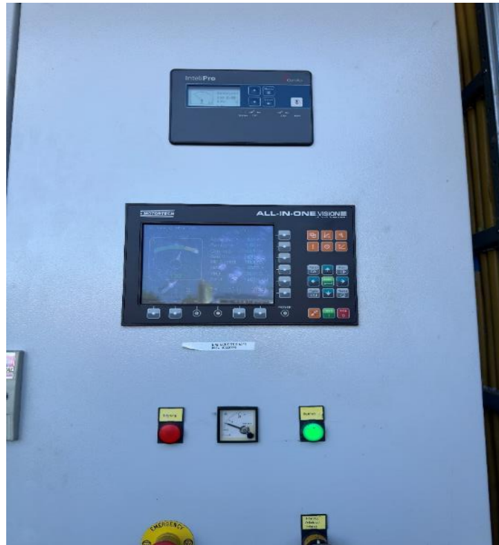
圖二、2-26.沼氣發電機面板
