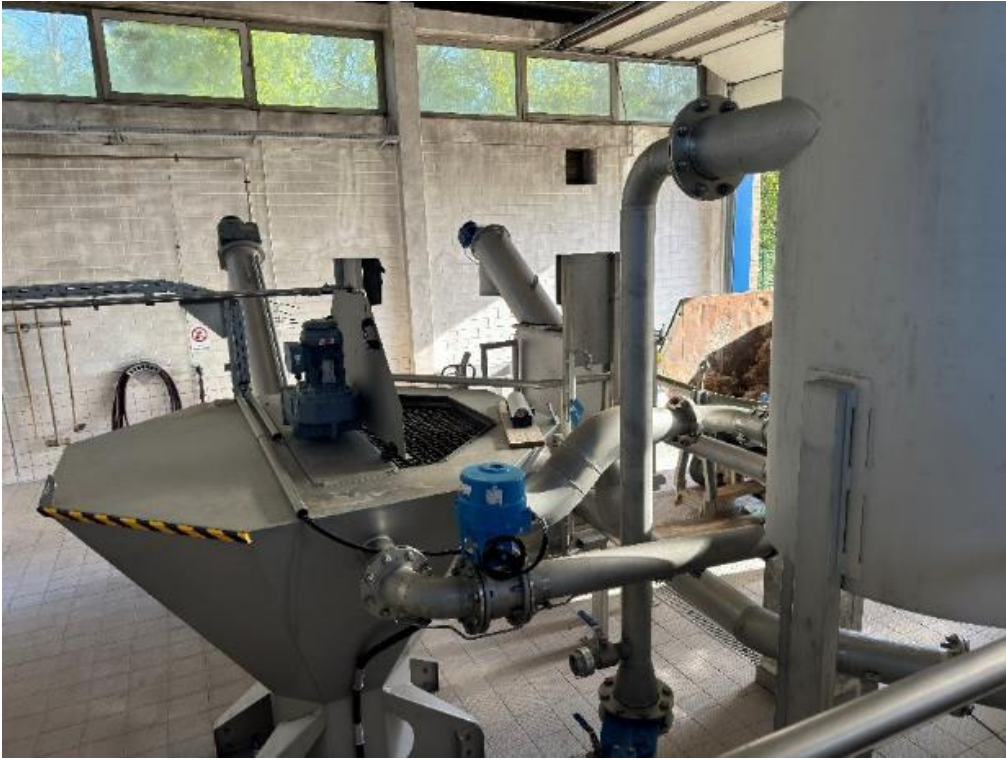
圖二、2-10.攔除物送至厭氧消化槽
