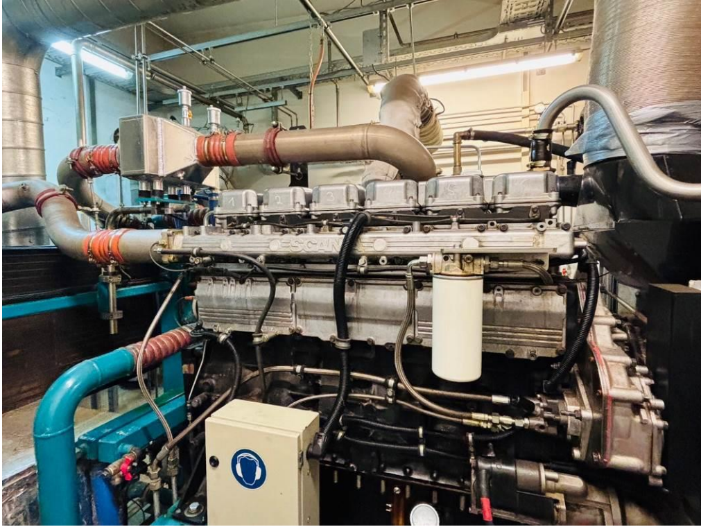
圖四、4-14.發電設備
