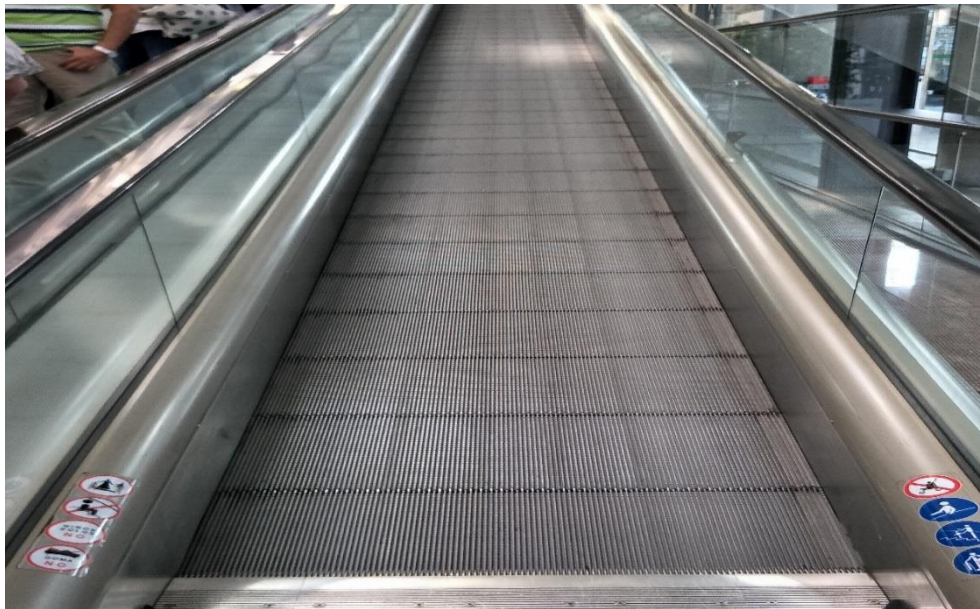
圖 30 馬拉加車站電扶梯，採用果嶺式設計，即像大賣場推著手推車走的電扶梯，行動中是平坦的，台灣車站一般採用階梯式的，
