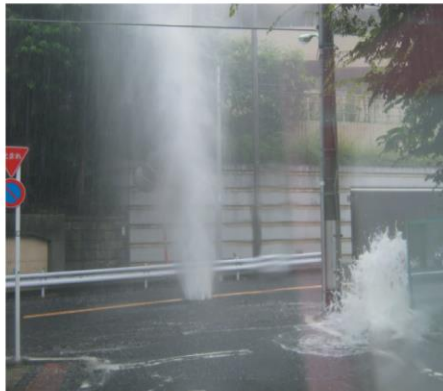
マンホールから水が噴き出している様子
