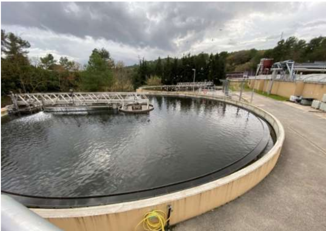
圖38 Grasse La Paoute MBR Plant 污水處理廠二級沉澱池
