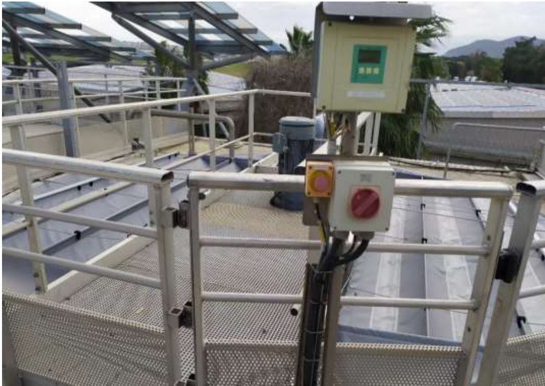
圖28 Aquaviva 污水處理廠之渦流沉沙池
