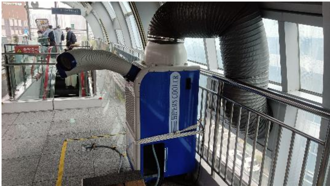
圖 39：站內設置大型風扇與制冷設備，提升乘客候車舒適度
