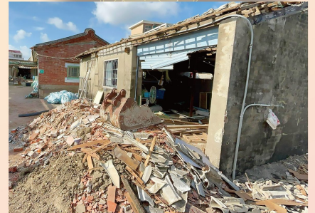
丹娜絲颱風重創鹽水後房屋受損嚴重
