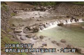
低落差壩體附設簡易型魚道
