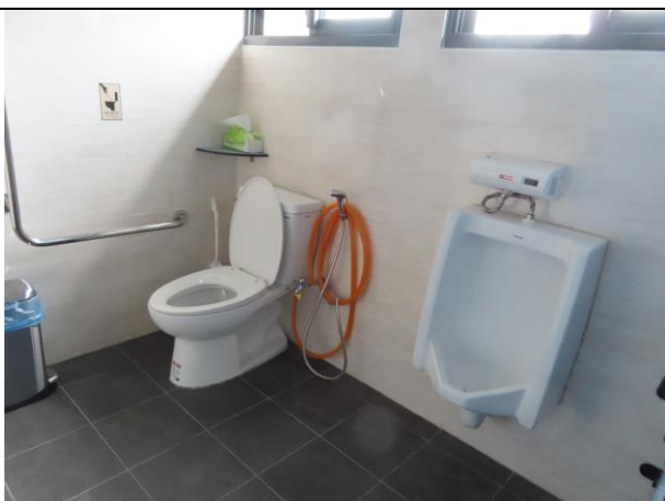
名稱：白河區清潔隊1F性別友善廁 地址：臺南市白河區河東里糞箕湖3號
