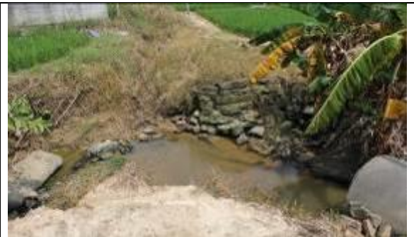
內角納骨塔區域排水溝渠轉彎處，易受雨水沖刷。
