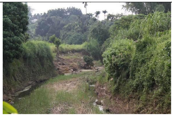
6 鄰 85 號附近野溪堤岸崩塌，宜儘快整治。
