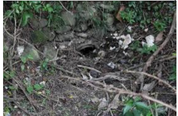
左圖排水至此太小且被堵塞之排水口，造成無法順暢排水。
