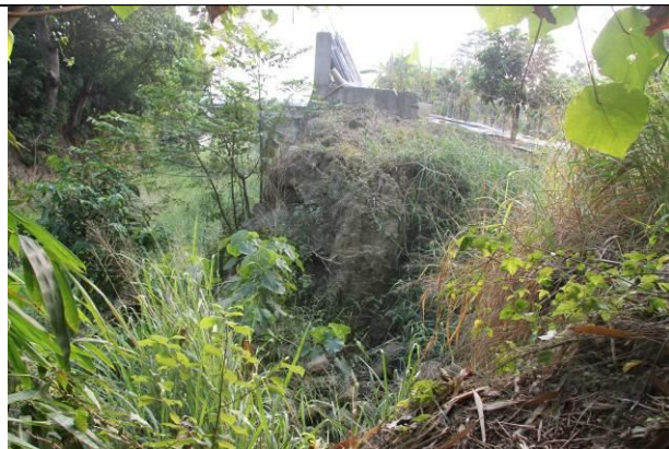
內角野溪內角橋附近尚未整建溪畔因大雨沖刷崩塌。
