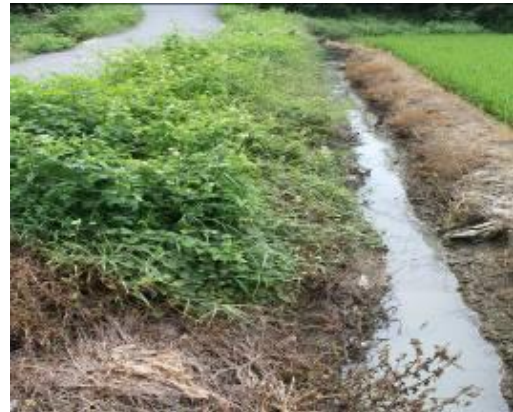
八鄰 97 之 5 號前產業道路排水溝渠侵蝕路面，出入路面狹小，宜建水溝。
