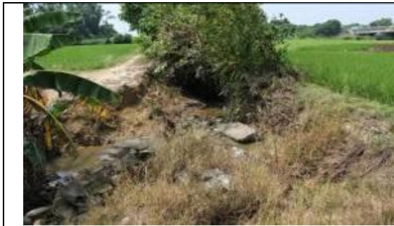
內角納骨塔區域排水溝渠為天然田間小渠，因雨沖刷塌陷，造成種植受災。
