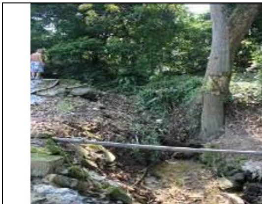
7 鄰 90 號附近傾斜區域，因雨沖刷成水道，宜建設排水溝。
