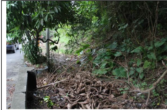
1 鄰 8 之 4 號沒有排水溝，已造成多次大雨灌入十多戶民宅。
