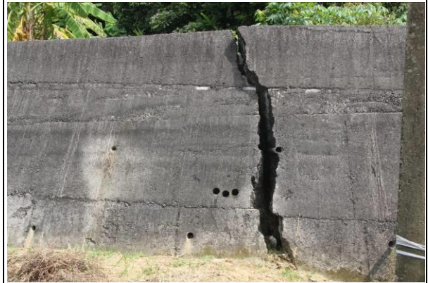
內角 95 號房舍後方擋土牆龜裂，上方土石可能壓垮房舍。
