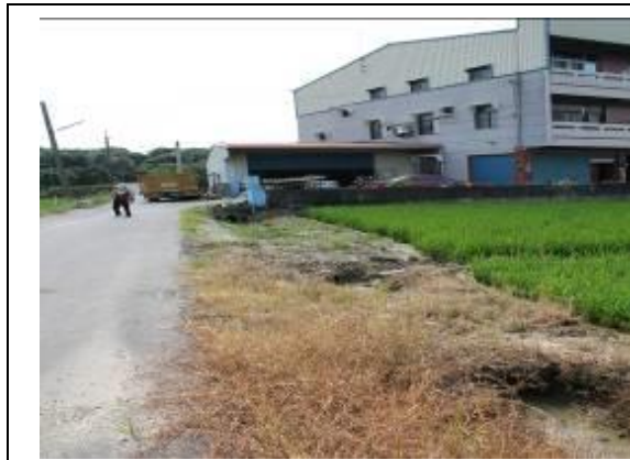
八鄰 97 之 5 號前產業道路排水溝渠侵蝕路面，出入路面狹小，宜建水溝。
