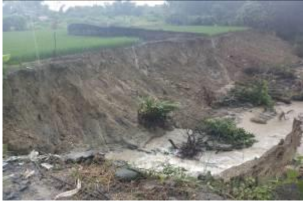
南縣道 86 號灌溉溝渠與野溪交會處因大雨沖刷崩塌。
