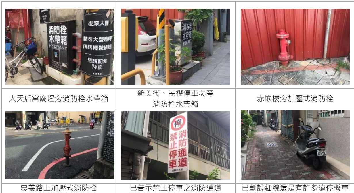
圖202. 相關消防設備現況照片
