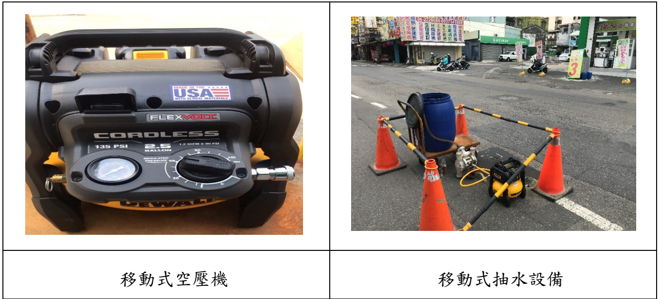
圖 4.3-38 移動式抽水設備
