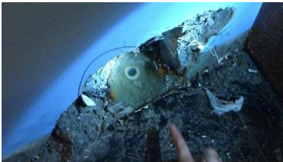
非結構牆內之自來水管破裂而滲水
