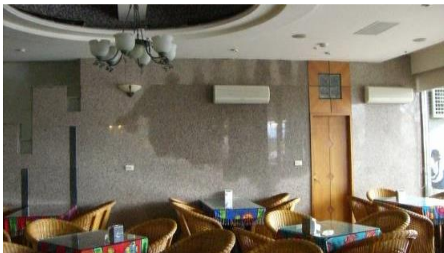
天花板、石材牆面之縫隙滲水情形
