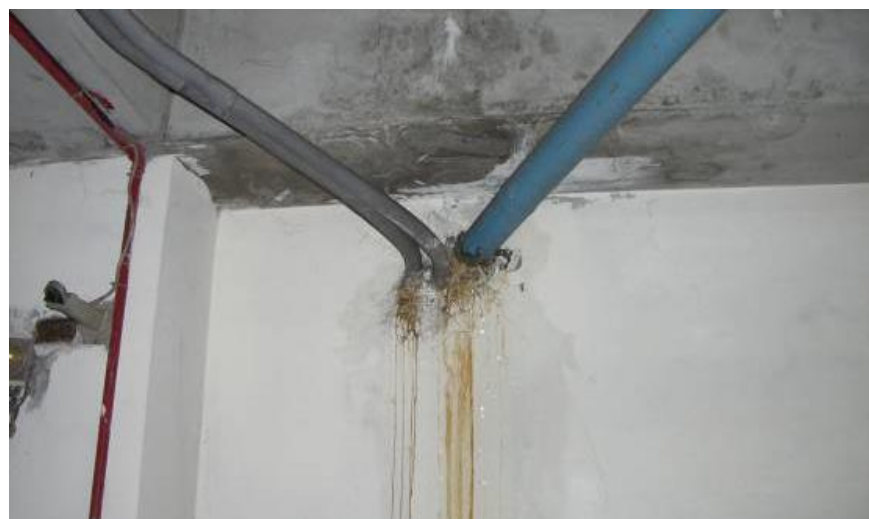
地下室水管穿牆處的滲水情形
