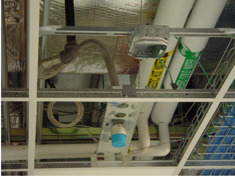
A) 消防管的柔性接頭
