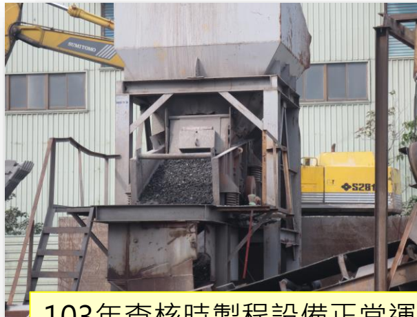
103年查核時製程設備正常運作
