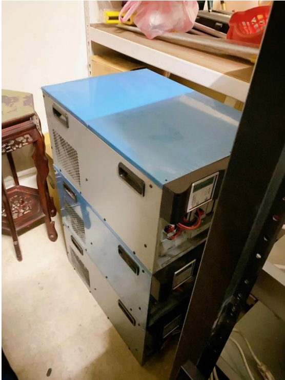
不中斷電源設備
