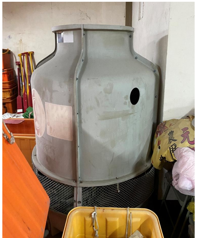
冷氣冷卻水塔
