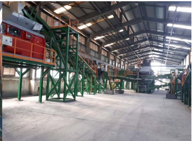
C. 廠內設備照片
