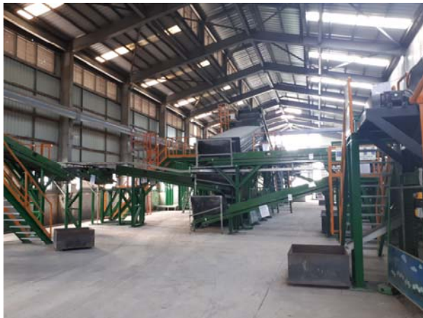
B. 廠內設備照片
