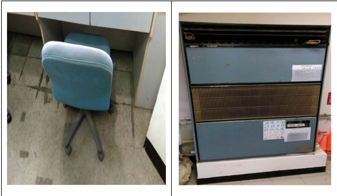
資料來源：107 年度前瞻基礎建設計畫(營造休閒運動環境)臺南市政府申請補助計畫
