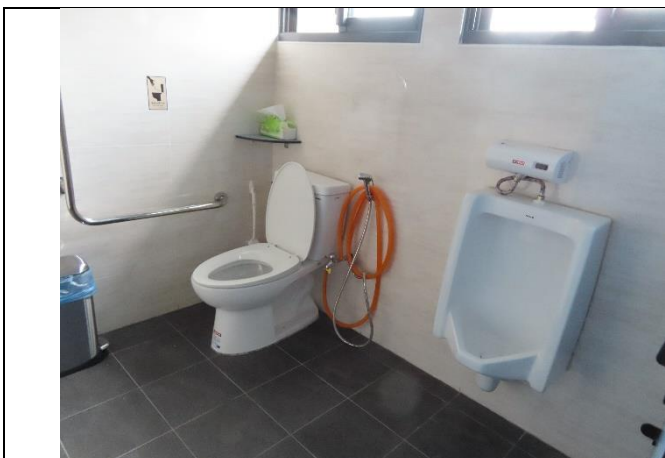
名稱：白河區清潔隊 1F 性別友善廁 地址：臺南市白河區河東里糞箕湖 3 號
