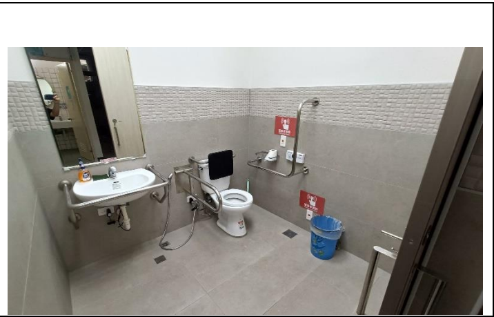
名稱：仁德區衛生所 1F 性別友善廁 地址：臺南市仁德區仁德里中山路 6 0 6 巷 2 號
