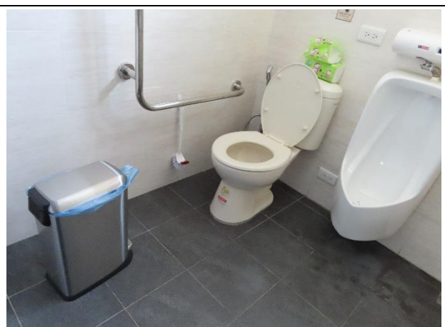
名稱：白河區清潔隊 2F 性別友善廁 地址：臺南市白河區河東里糞箕湖 3 號
