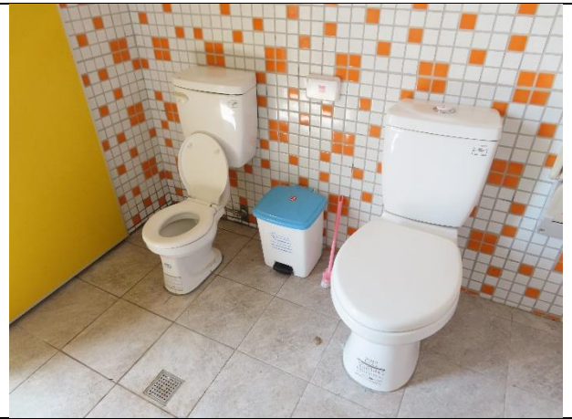
名稱：臺南市新營體育場田徑場北側親子廁 地址：臺南市新營區護鎮里長榮路二段78號
