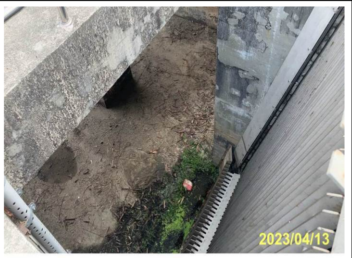
水質(本案施工期間之沈砂池排水口)無水情形
