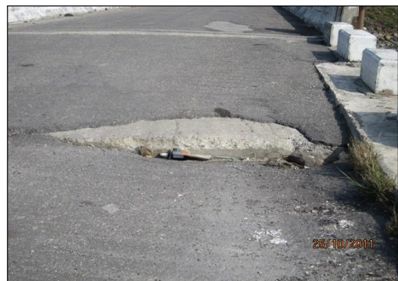
橋面 AC 鋪面剝落
