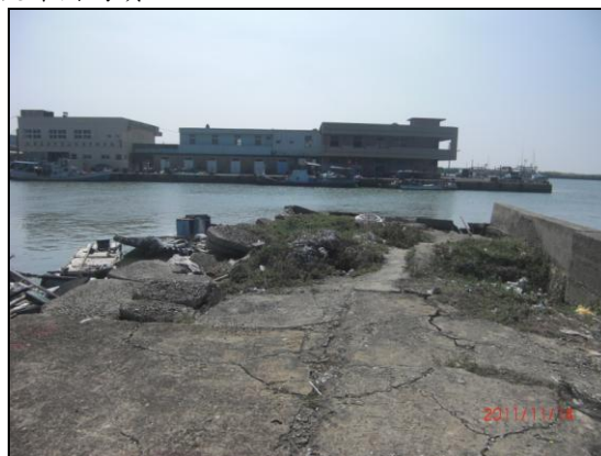
北突堤堤頭(塌陷)
