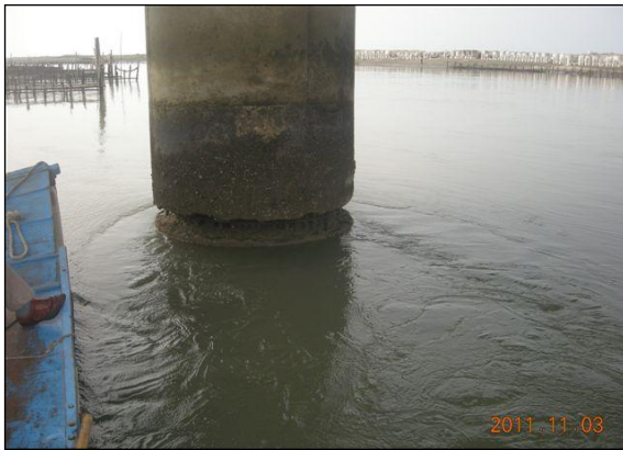
橋墩柱體混凝土侵蝕
