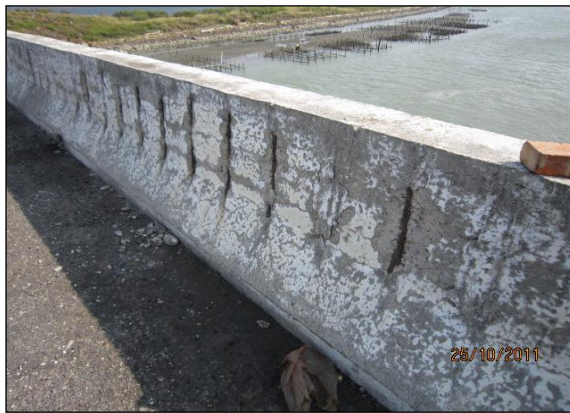
橋面護欄鋼筋鏽蝕外露
