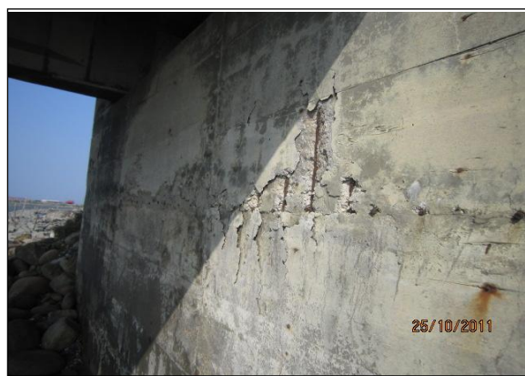
橋台鋼筋鏽蝕外露
