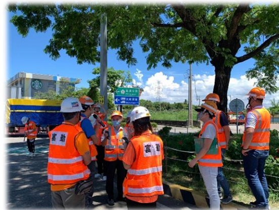
張副分局長領隊工程安衛稽核-112.08.21岡山段交通設施維護工程(112)
