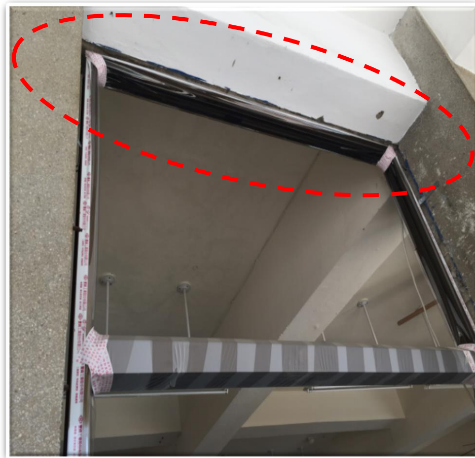
鋁窗未四邊固定，固定鐵件間距不符規範
