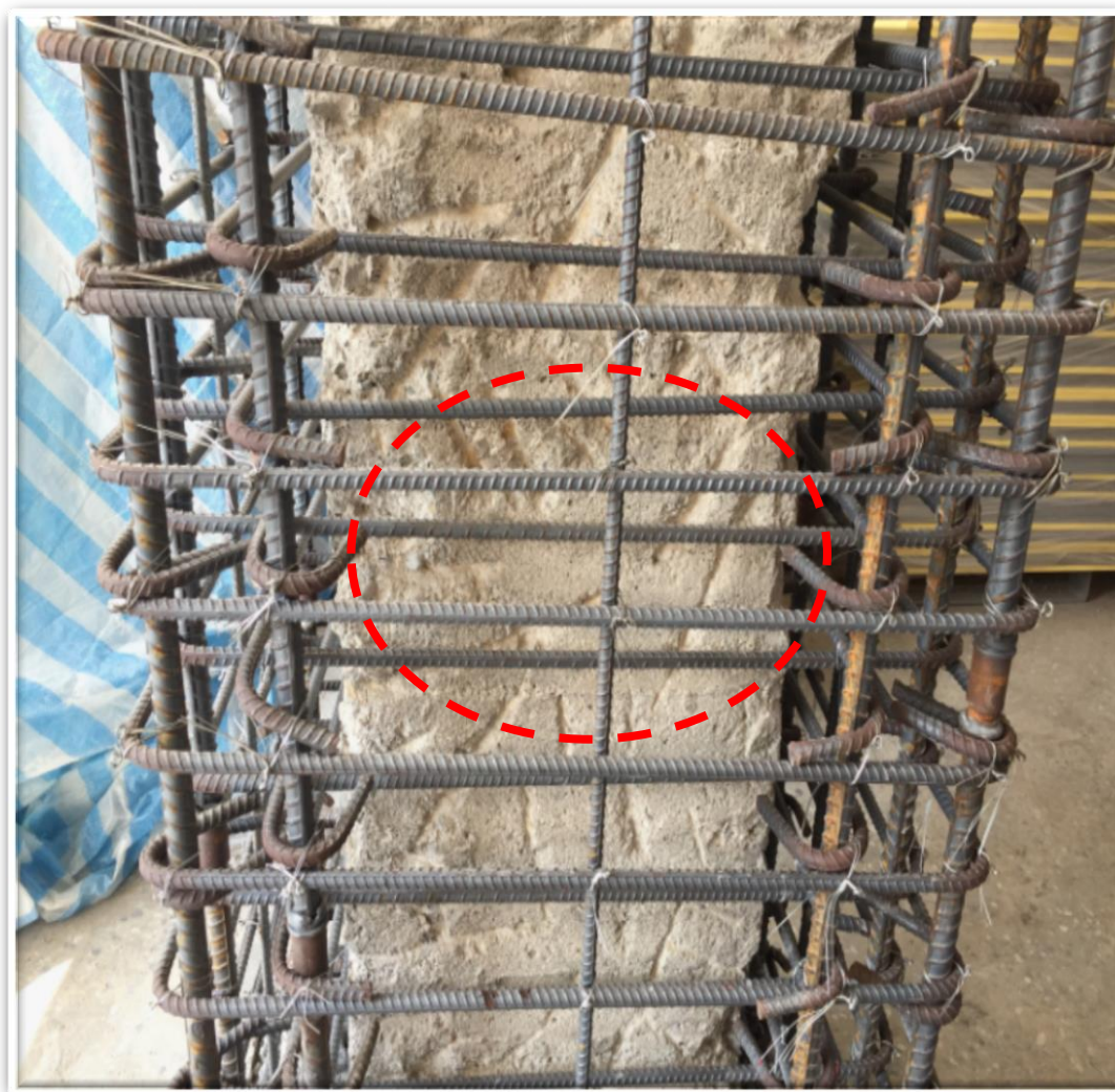
粉刷層未打除乾淨
