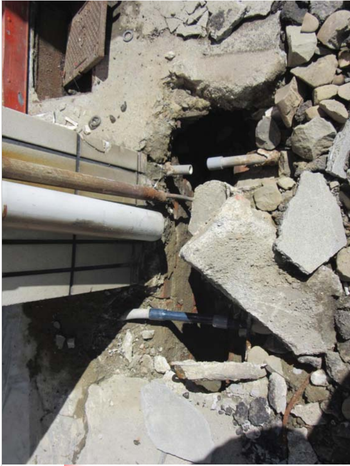
新市區三民街50巷液化，主結構沈陷，自來水管拉脫
