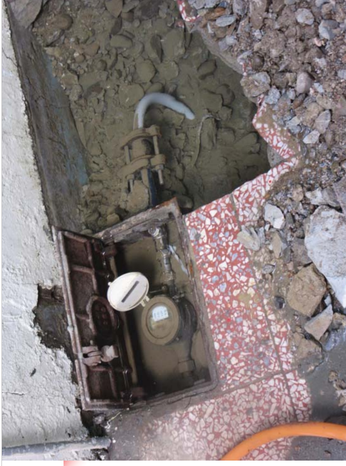
中西區文和街液化沈陷自來水管拉斷修補
