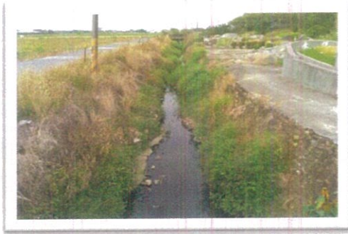
通水斷面不足
