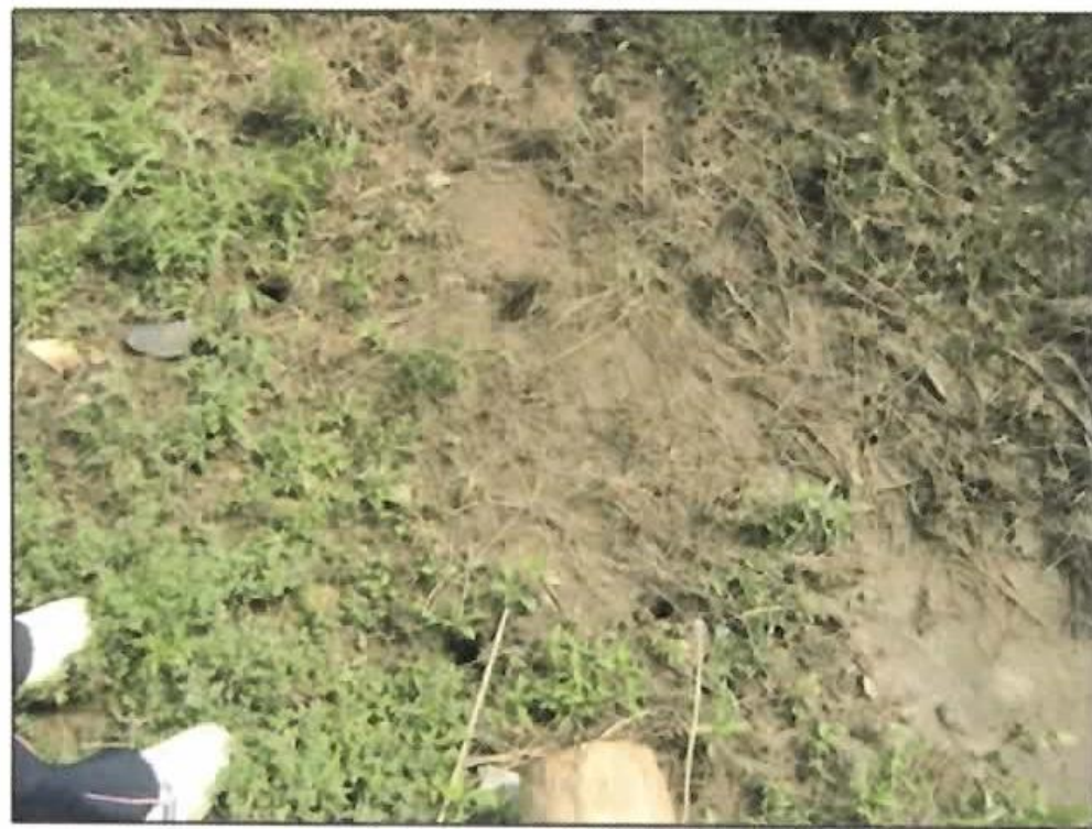
堤防で確認された孔 矢部川決壊地点上流
