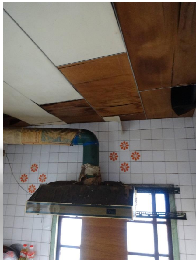
廚房天花板破損
