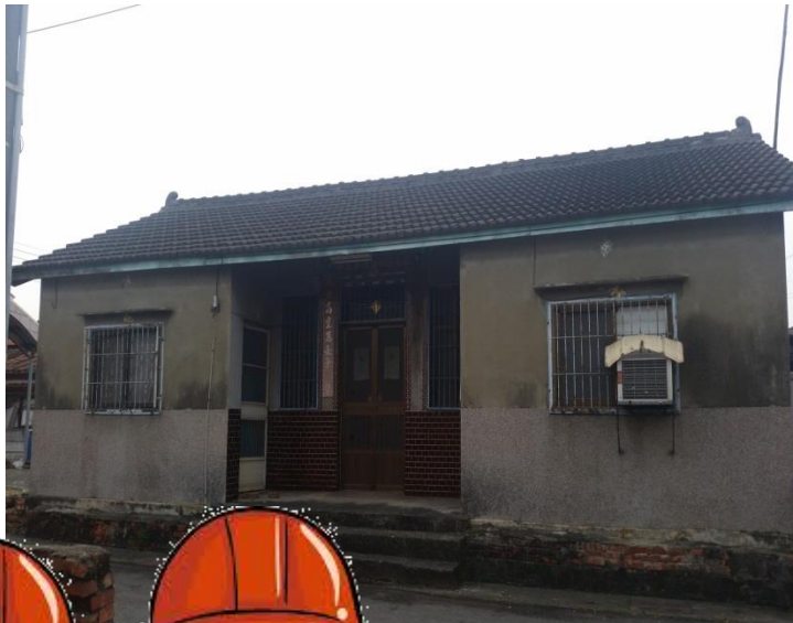
部分屋瓦破損
