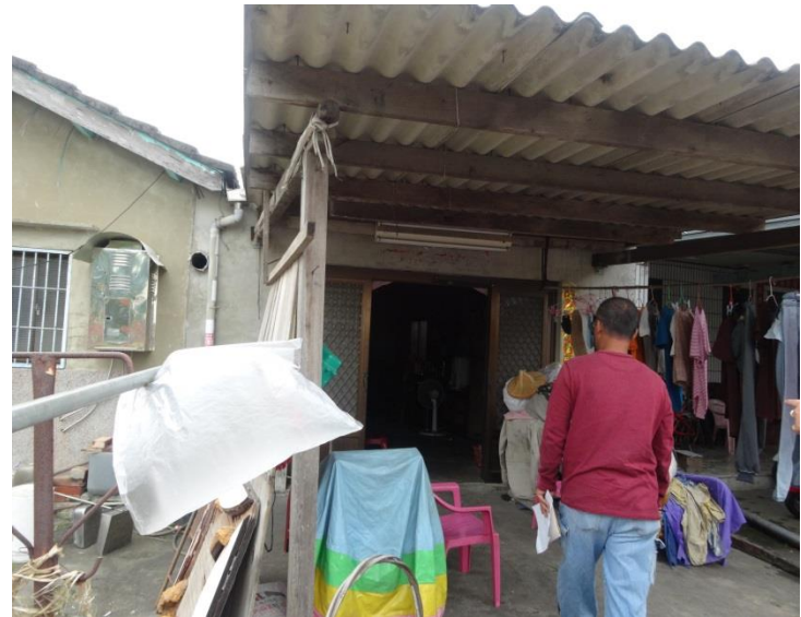
遮雨棚老舊破損
