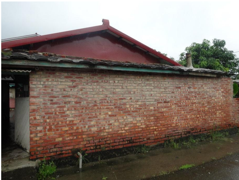
廚房屋頂漏水
