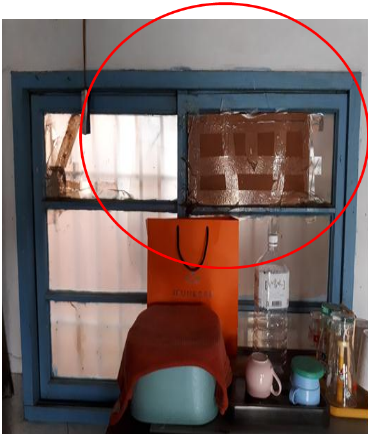
修繕前(廚房窗戶)
