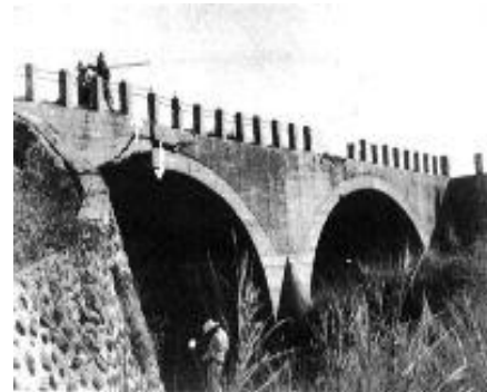
新化鎮思橋(改建後更名為深坑橋，中山路上，台 20 號公路)北端橋拱中央斷裂，斷裂處之北側橋體上升 (陳培源教授提供)。
