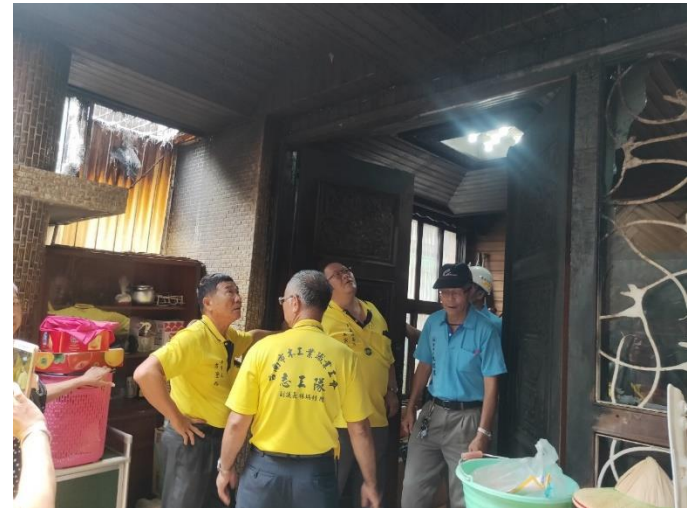
案家大門損壞
