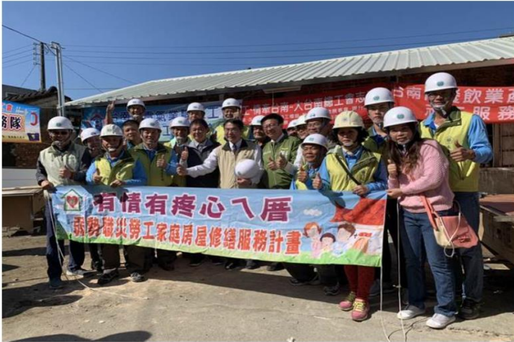
台南市長黃偉哲（左五）訪視勞工局「有情有疼心入厝」第100戶弱勢勞工家庭房屋修繕施工。（南市勞工局提供 / 劉秀芬台南傳真）
