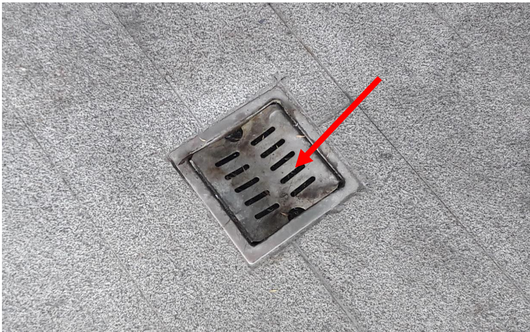
相片 6、月台及廁所外側方形排水孔蓋板已受壓變形，建議改裝較厚耐重壓之蓋板。
