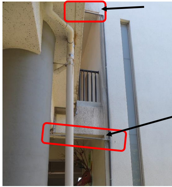
相片 5、走廊伸縮縫導水橫管及立管，管徑太小，抗風力不足，易受風損壞，建議將各樓層排水橫管導入屋頂排水管內或其他較妥適之排水方式。
