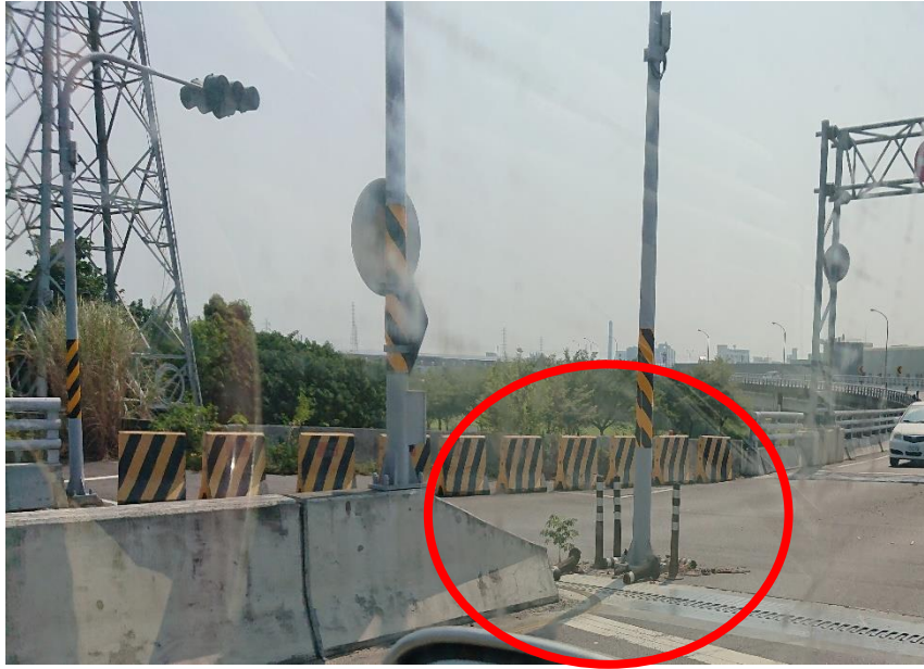
相片 7、跨河段橋梁南側之中央分向島島頭防撞桿破損。
