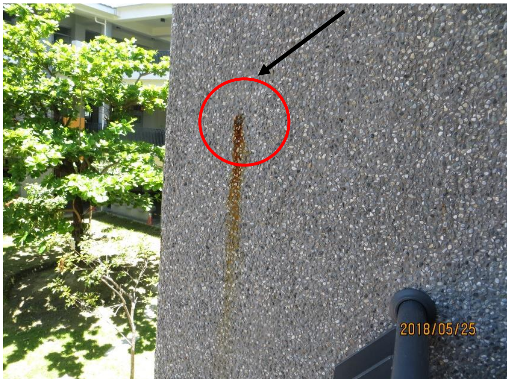
相片 8、小部分樓板(3樓)水泥砂漿粉刷層有單點剝落及抵石子單點鏽水滲出狀況，建議定期觀察變化。
