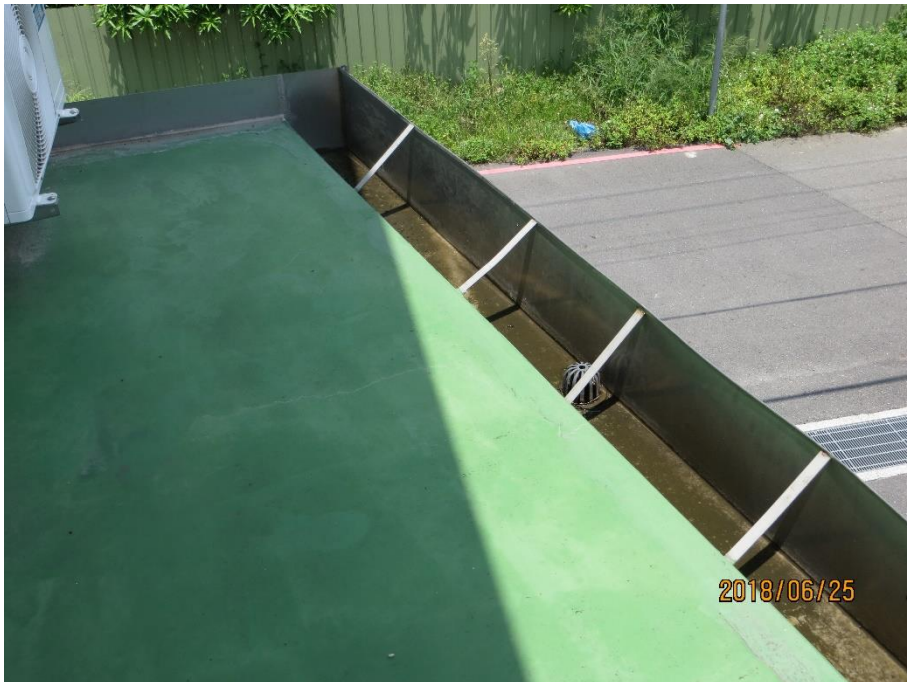
相片 14、二樓西北隅天溝已有淺積水現象，建議調整排水管落水頭高程或調整溝坡，避免成為孳生源。
