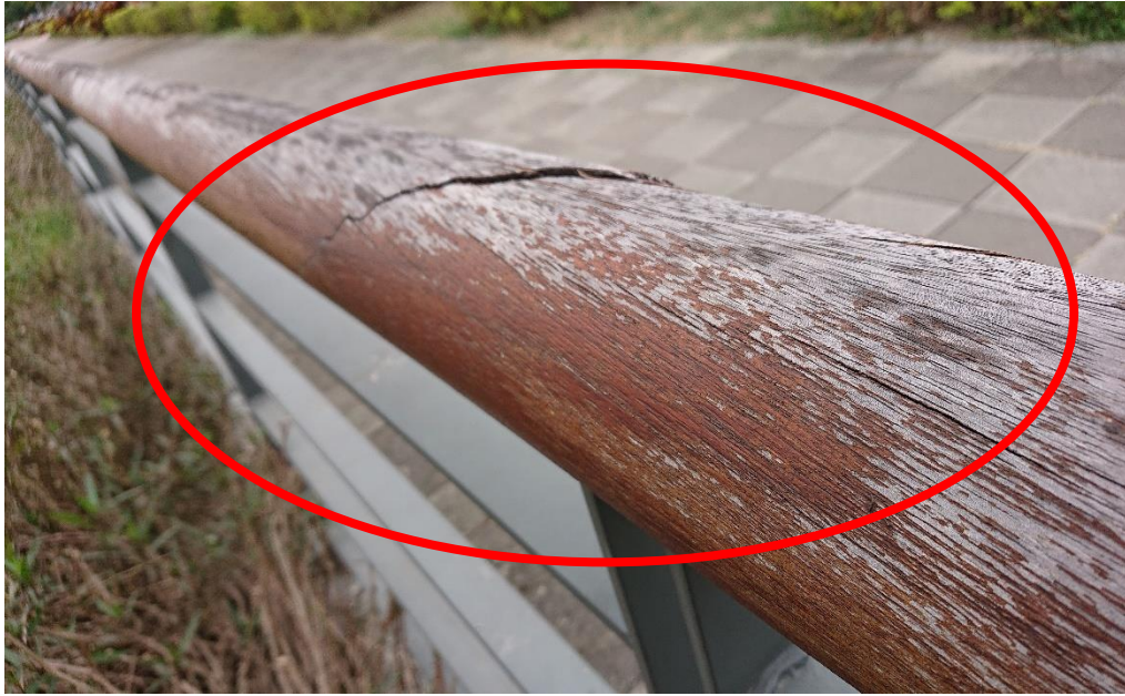
相片 3、部分木作欄杆目前已脫漆甚至產生裂紋，應予改善，重漆前應請廠商徹底清除以前殘留之漆膜。
