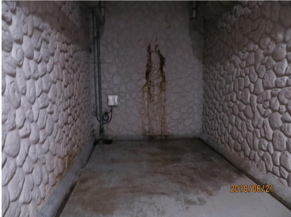
相片 1、二座礫間曝氣池間之參觀廊道內有水滲漏痕跡，宜改善。
