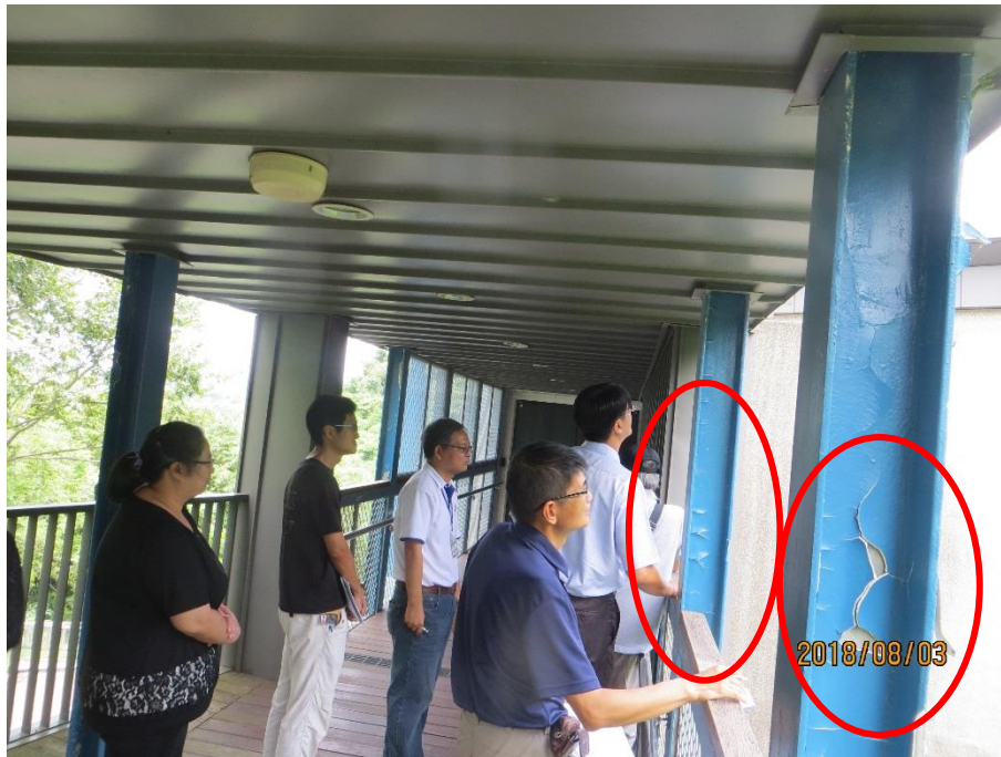
相片 3、展示館與星象館空橋間逃生通道鋼柱防水材部分剝落。
