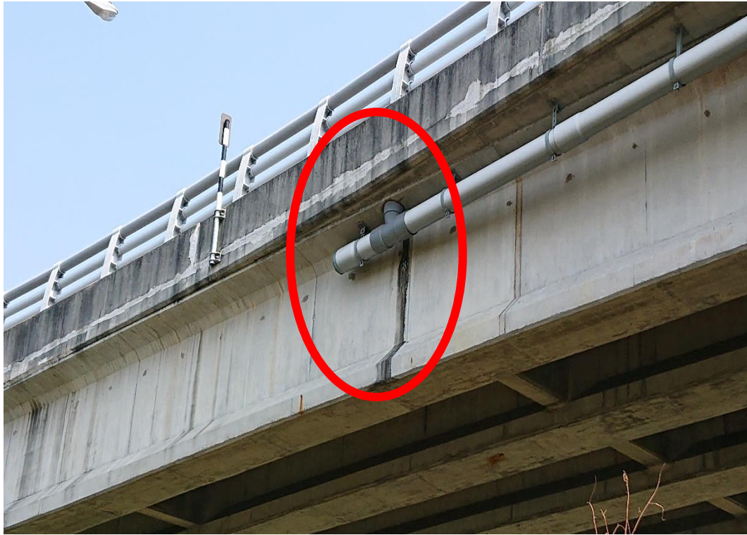
相片 3、橋側翼板下方之部分橋面洩水孔因水溢出造成混凝土面外觀有水痕，請檢修。
