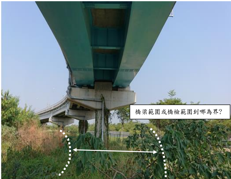
相片 8、檢測及維護的範圍宜釐定清楚(例如：橋梁下方的範圍，以何為界，屬橋梁範圍，以外屬其他範圍)，以避免三不管的現象。
