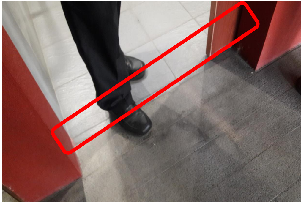
相片 24、建議男女廁及無障礙廁所門口處後續建案設計時，可設置全線型截水溝，以利清洗廁所時阻絕污水外溢。
