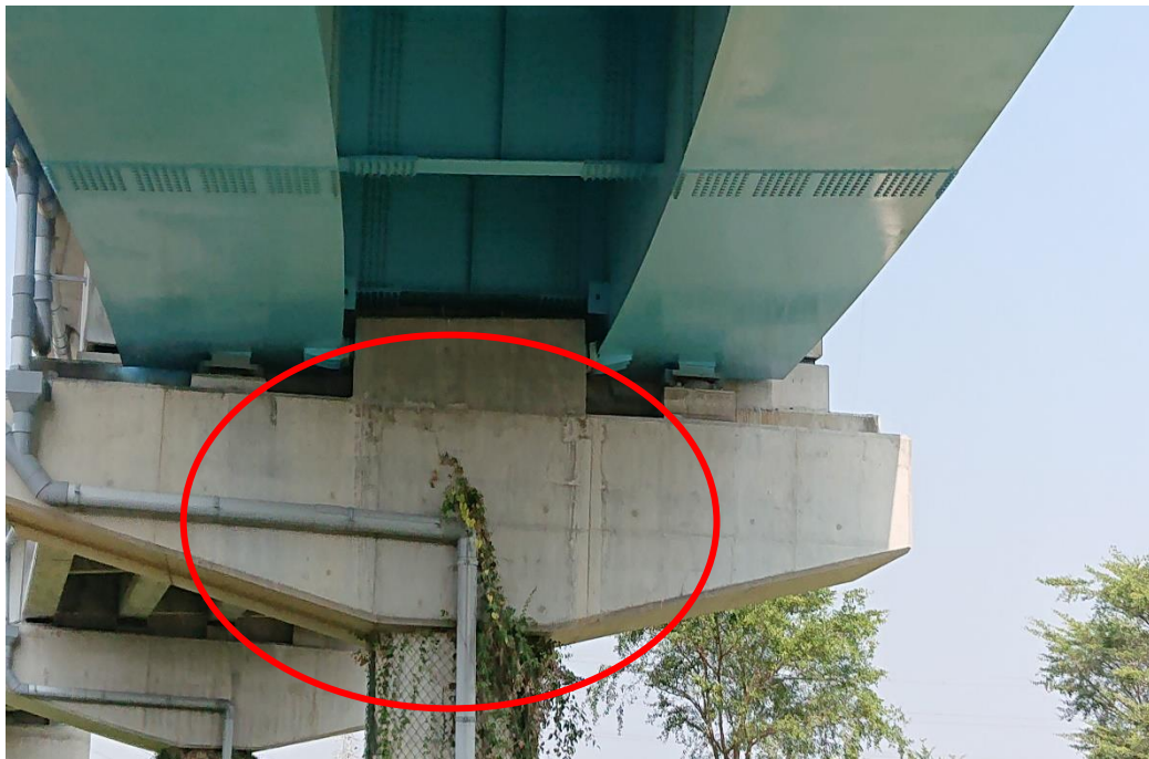
相片 4、橋墩下之植生爬藤已包覆墩柱，影響對墩柱結構物之目測檢視，而日後植生爬藤頂上生長至帽梁、支承座或鋼箱梁，則雨季時因植生攀附造成濕氣不易散失，致加速鋼箱梁等構件加速生鏽，且增加日後維護及檢測作業困擾。
