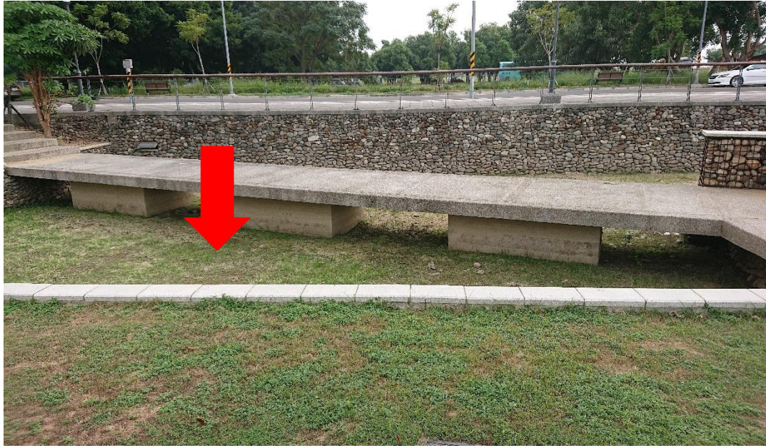
相片 1、生態滯洪池池地原設計為不易透水之黏土，現因里民反映可能成為登革熱病媒蚊孳生場所而需以動力方式遇積水抽排，如地下層為透水良好地層，建議將打設垂直滲透管 之方式列為主動排水方式之一。
