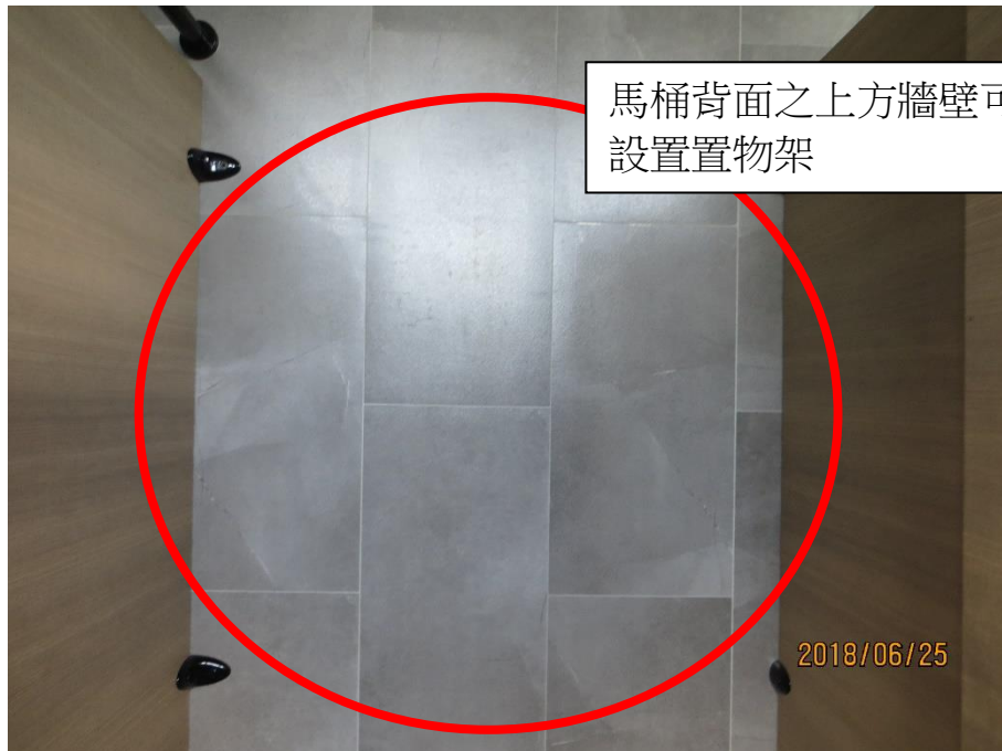
相片 27、建議視情況於男廁小便斗及男女廁之馬桶間設置置物架或掛勾以利旅客如廁時置物。
