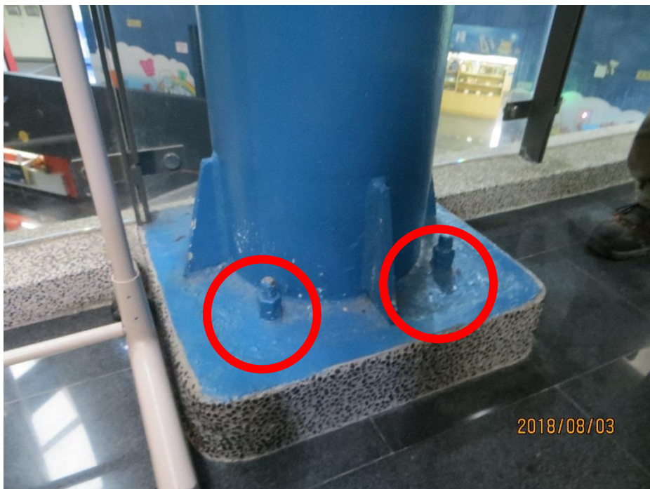
相片 4、星象館星象劇場鋼柱螺栓未防護。
