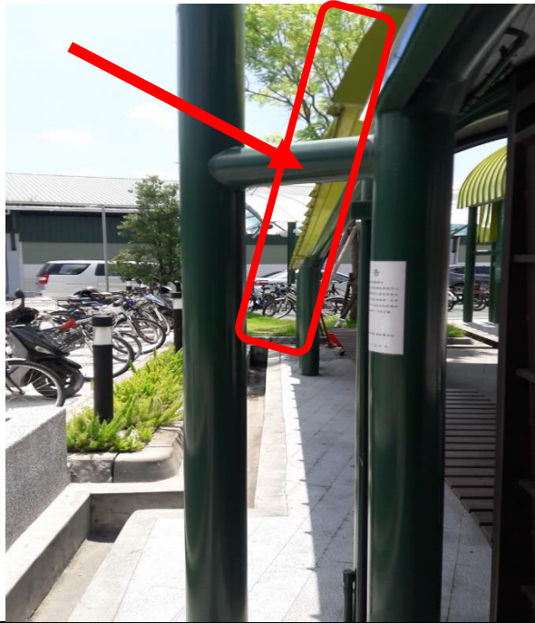
相片 5、月台遮棚及自行車停車棚前後屋簷建議加設集排水槽，可避免雨水觸地後噴濺候車民眾。
