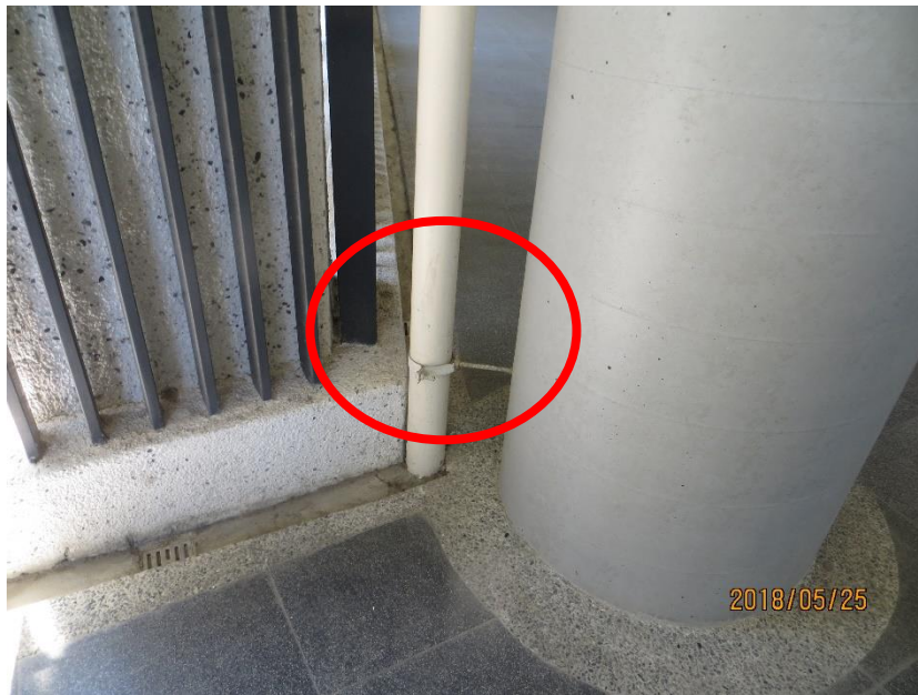
相片 7、圓柱旁落水管夾具鐵件有學生碰撞安全之虞。
