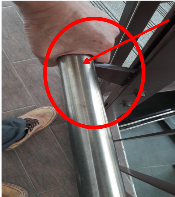
相片 9、無障礙樓梯扶手架設支桿與人手虎口抵觸，不符『建築物無障礙設施設計規範 207.2.2』規定，建議改善。
