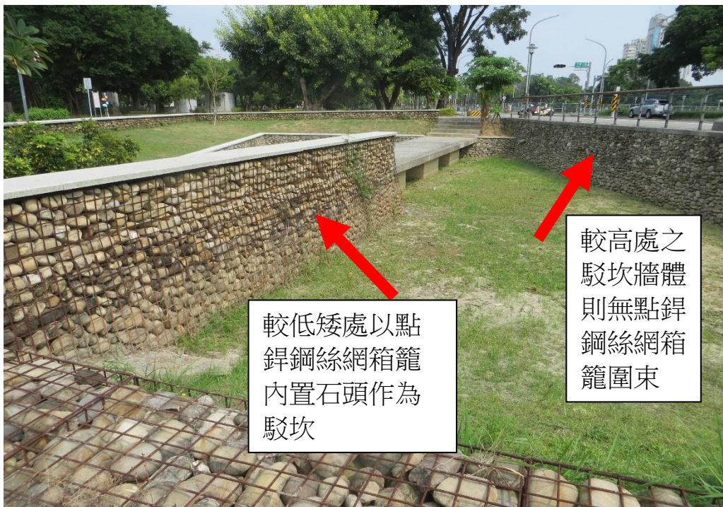
相片 10、生態滯洪池內之駁坎牆體設置方式與使用功能矛盾，較低矮處以點鉚鋼絲網箱籠內置石頭作為駁坎，而較高處之駁坎牆體則無點鉚鋼絲網箱籠圍束。
