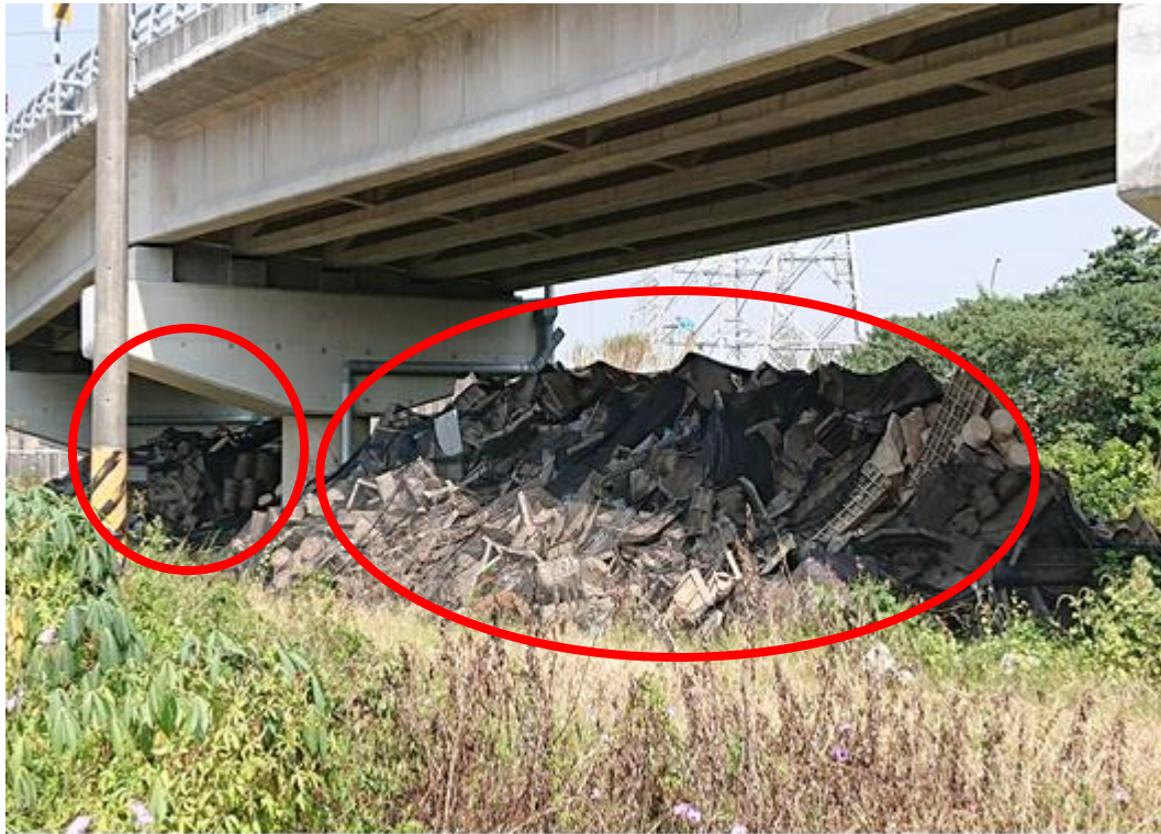
相片 5、橋下堆置垃圾宜清除，如發生大火將影響橋梁結構。
