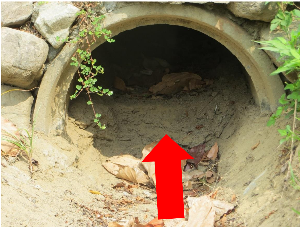
相片 6、排水管涵內有淤沙，宜請清除並考慮於端口設置沉沙池，以減少排水管涵內淤沙。
