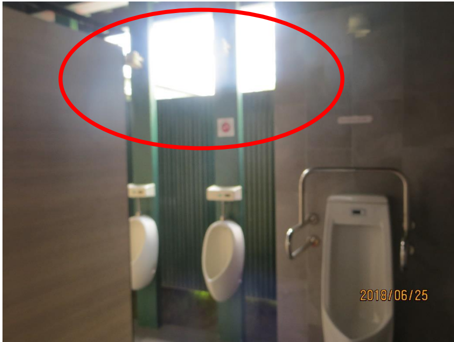
相片 29、男廁小便斗上方透空設計宜請注意雨水是否會潑入造成地板濕滑致旅客跌倒。
