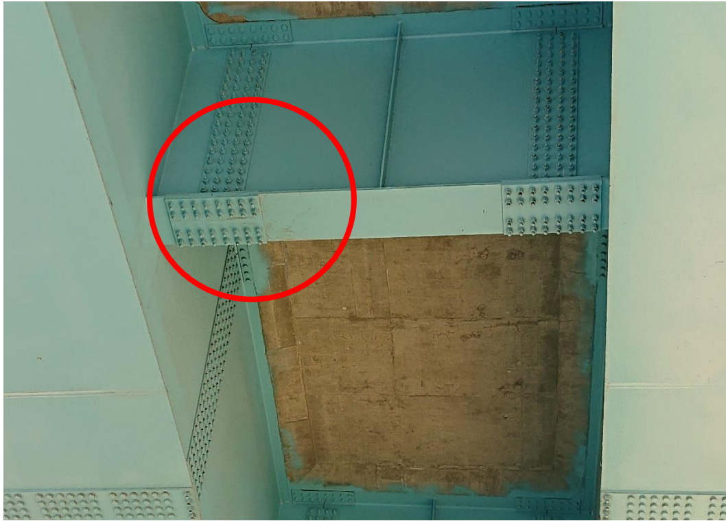
相片 1、鋼箱梁底少數螺栓生鏽。
