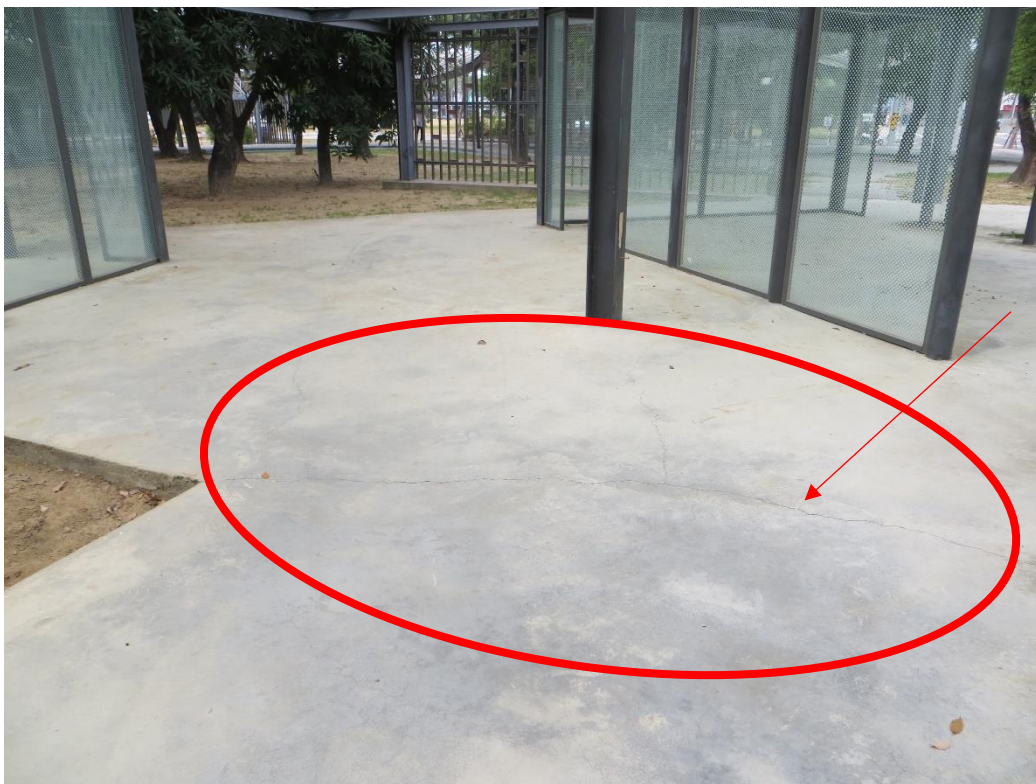
相片 12、藝文空間棚架下方地坪混凝土收縮裂縫明顯，於設計時應考量設置伸縮縫，以減少裂縫。
