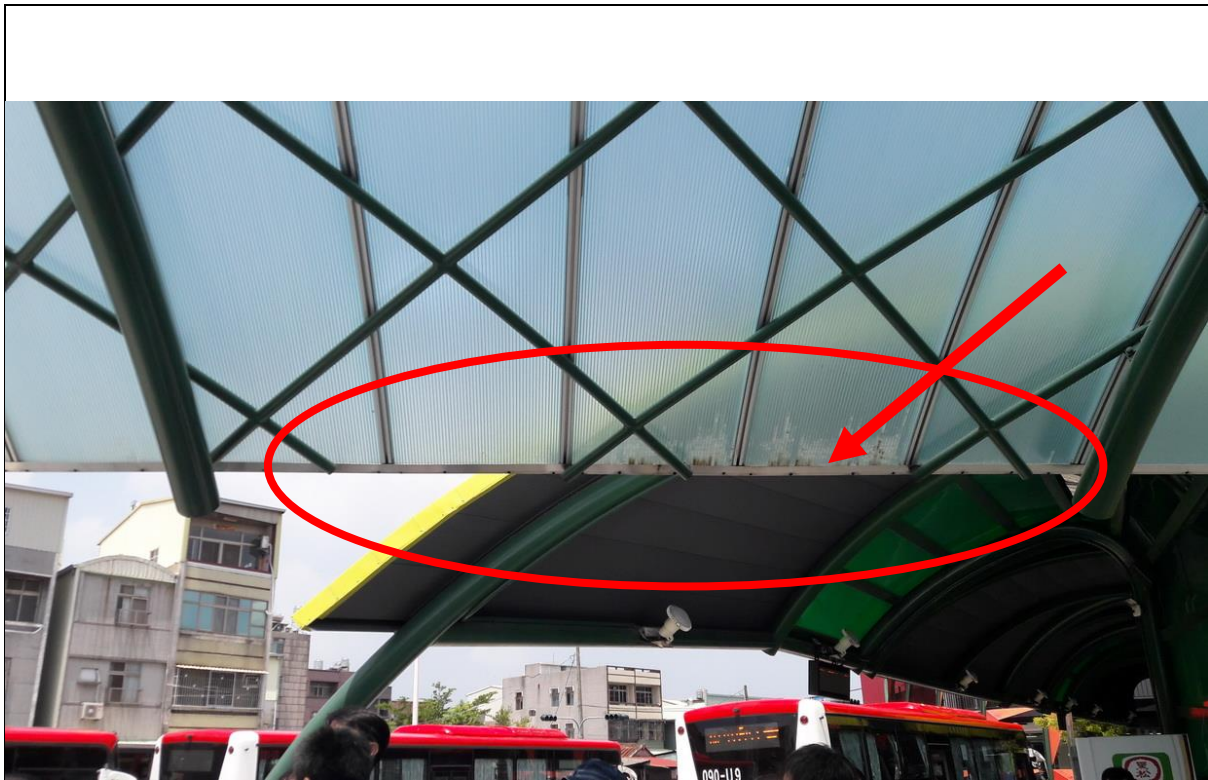
相片 15、自行車停車棚中空板下緣已因水氣入滲產生發霉污損現象，建議加設遮板或黏貼膠布遮醜。
