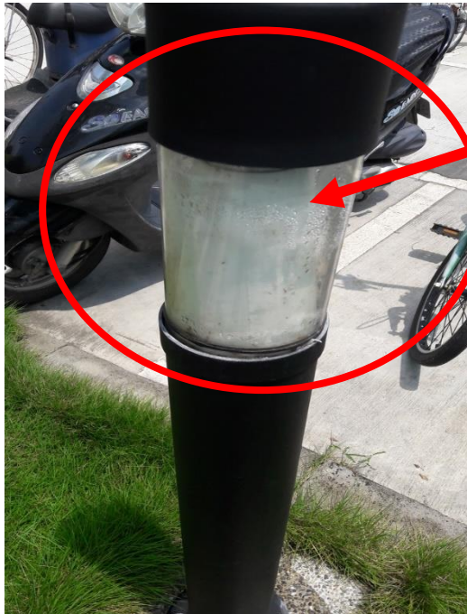
相片 13、戶外景觀立燈玻璃罩內面水氣建議設法排除，避免燈具浸潤受損及預防感電事件。
