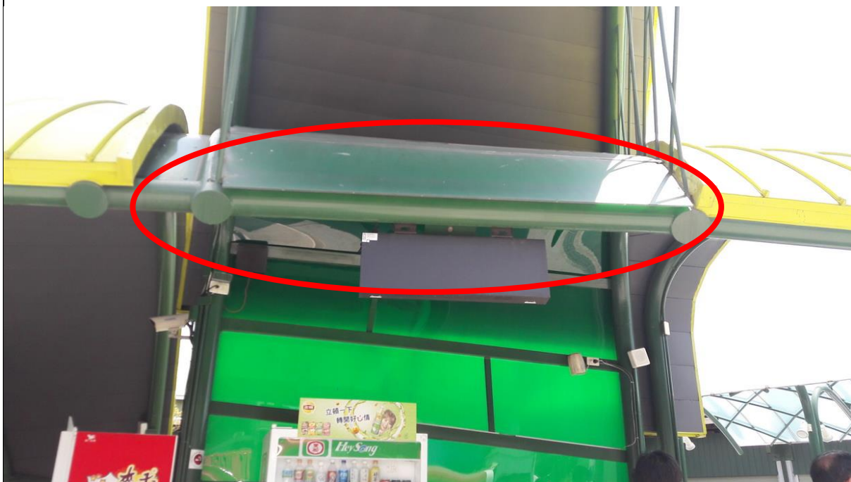
相片 16、月台候車遮棚採用壓克力弧面罩，建議於開放端外側加設壓條，可避免颱風時負壓強風掀離。
