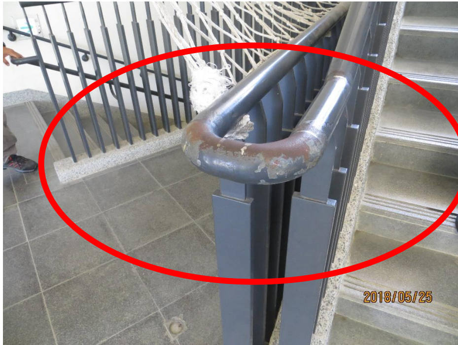
相片 3、樓梯烤漆欄杆轉角處，烤漆脫落，部分生鏽。
