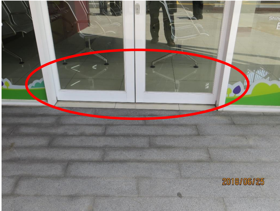
相片 25、建議如站體一及二樓之外露進出口處於後續建案設計時，可設置全線型截水溝，以防颱風時風雨由底部門縫滲入室內。
