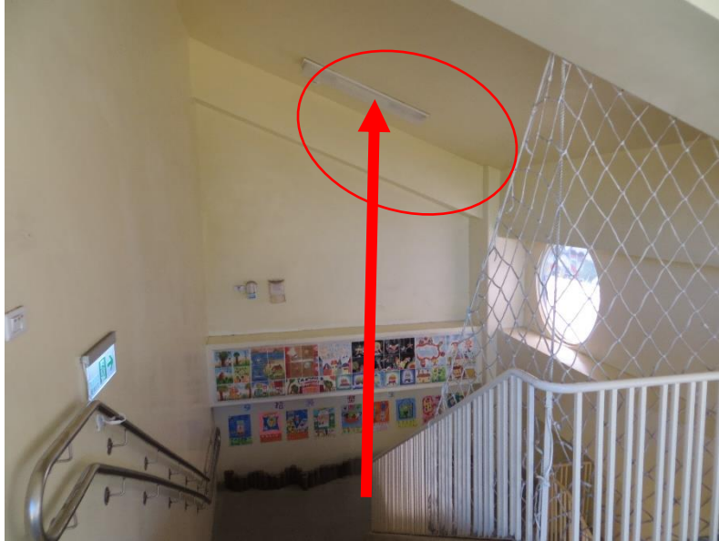
相片 27、樓梯間之照明日光燈過高，日後不易更換，建議爾後設計時可於四周牆壁適當高度設置照明燈具。
