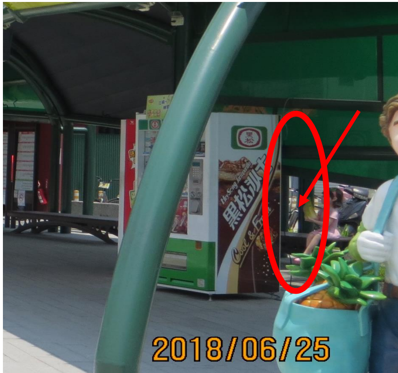
相片 23、飲料販賣機電源線外露應速改善。
