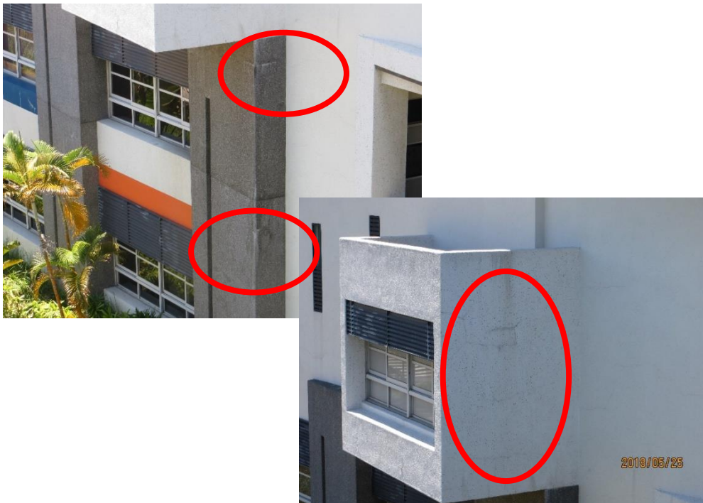
相片 6、外牆仿石漆塗料未設勾縫，導致不規則裂縫或外壁產生白華。
