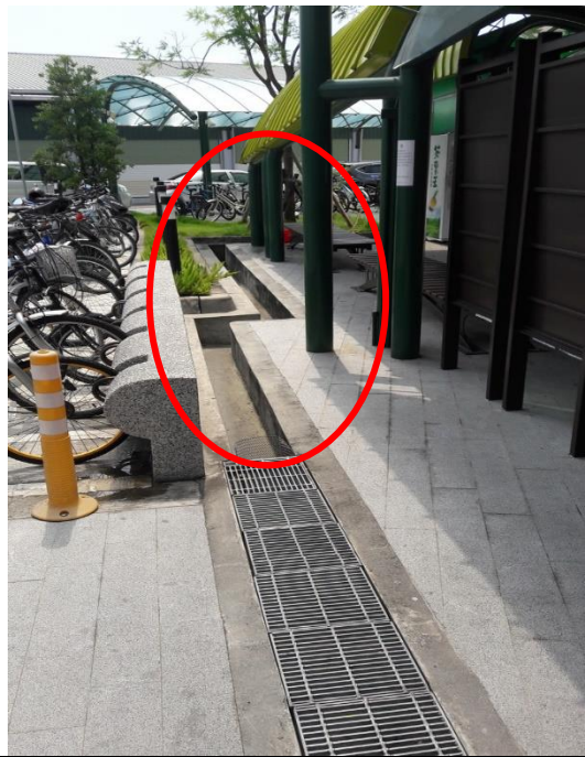
相片 1、月台周邊（與綠地交界處）之雨水排水溝，建議加封蓋板，避免民眾誤入絆跌。
