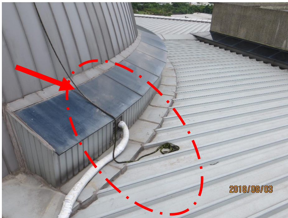
相片 2、球形屋頂檢修繩老舊（未設檢修梯）。
