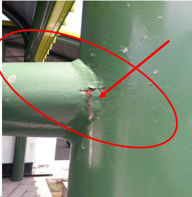
相片 21、部份鋼管接合焊道及二樓 Deck 樓版收邊豎板漆面剝脫現象，建議補強。
