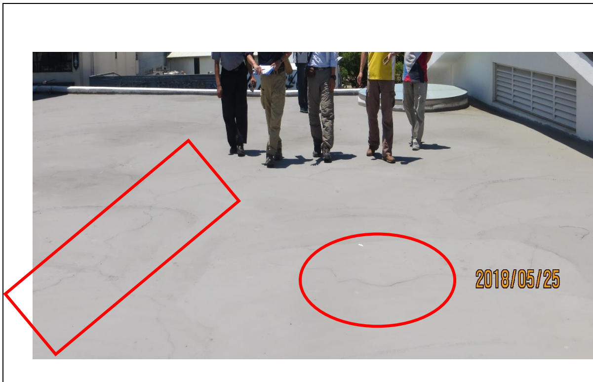
相片 9、屋頂平台，保護層多處龜裂破損。
