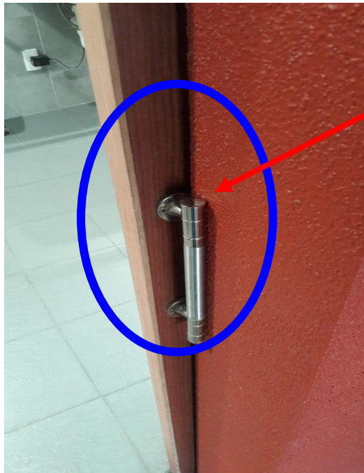
相片 10、無障礙廁所拉門門把不符『建築物無障礙設施設計規範 504.2』規定，建議改善。
