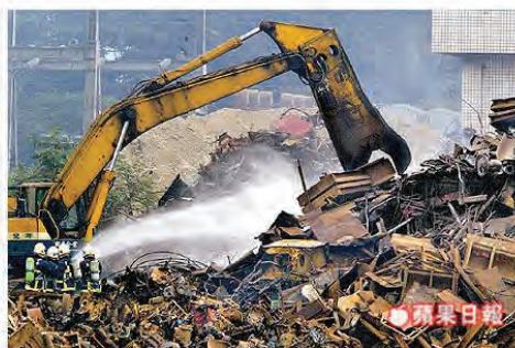
震臺鋼鐵公司發生氯氣外洩意外，消防隊員趕往現場噴灑水霧稀釋氯氣濃度。張世瑜攝
