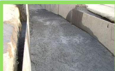
可添加於控制性低強度混凝土(CLSM)作為回填材料
