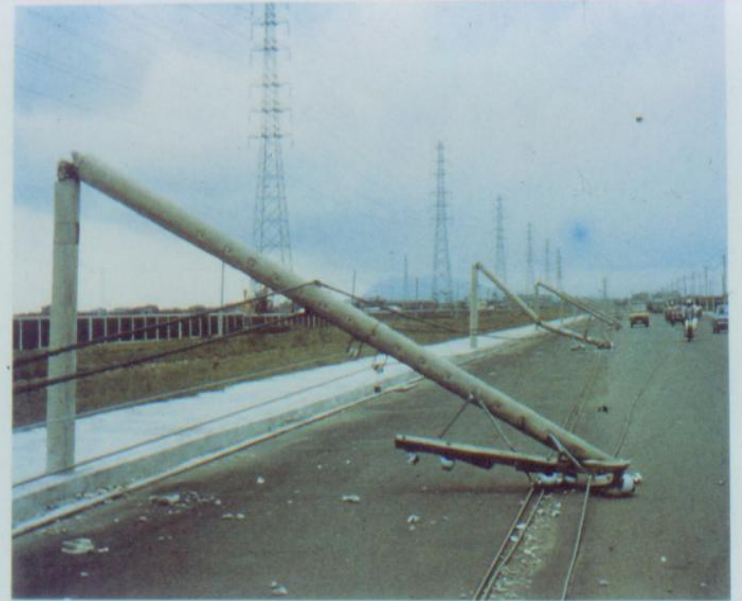
照片四，台灣電力公司電桿從腰部被暴風吹斷，乃因鋼筋配置突然減少，抗風力不足，致有一排電桿折斷部位高度一致。
