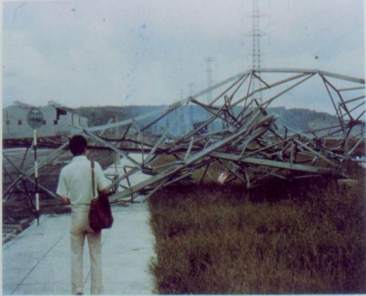
照片三，66年7月25日賽洛瑪颱風登陸高雄時，台灣電力公司輸電鐵塔被暴風吹毀。
