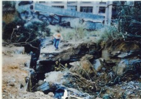
汐止林肯大郡災變現場 (86年8月18日溫妮颱風侵襲期間)
