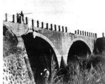
新化鎮思橋(改建後更名為深坑橋，中山路上，台 20 號公路)北端橋拱中央斷裂，斷裂處之北側橋體上升 (陳培源教授提供)。
