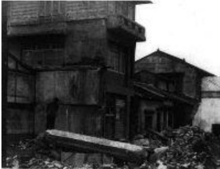
新化鎮護國里三層樓之鋼筋混凝土建築物倒毀 (1946.12.23 攝，陳培源教授提供)
