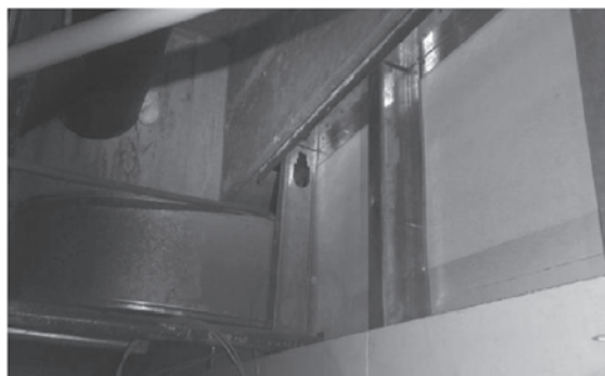
輕隔間牆封板不確實
