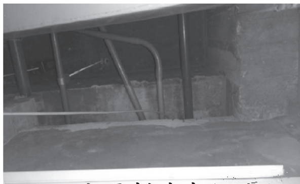
防火區劃牆未封堵
