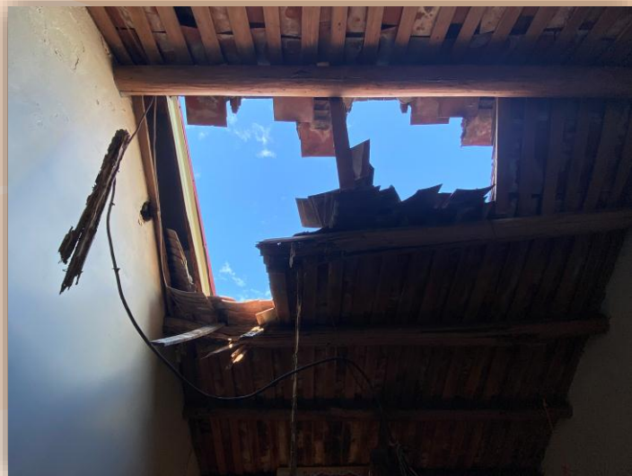
天花板修繕前
