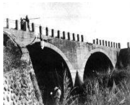
新化鎮思橋(改建後更名為深坑橋，中山路上，台 20 號公路)北端橋拱中央斷裂，斷裂處之北側橋體上升 (陳培源教授提供)。
