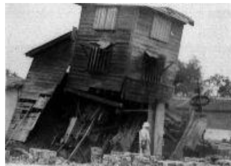
新化鎮木造榨油廠傾倒 (1946.12.23 攝，根據張麗旭等(1947))
