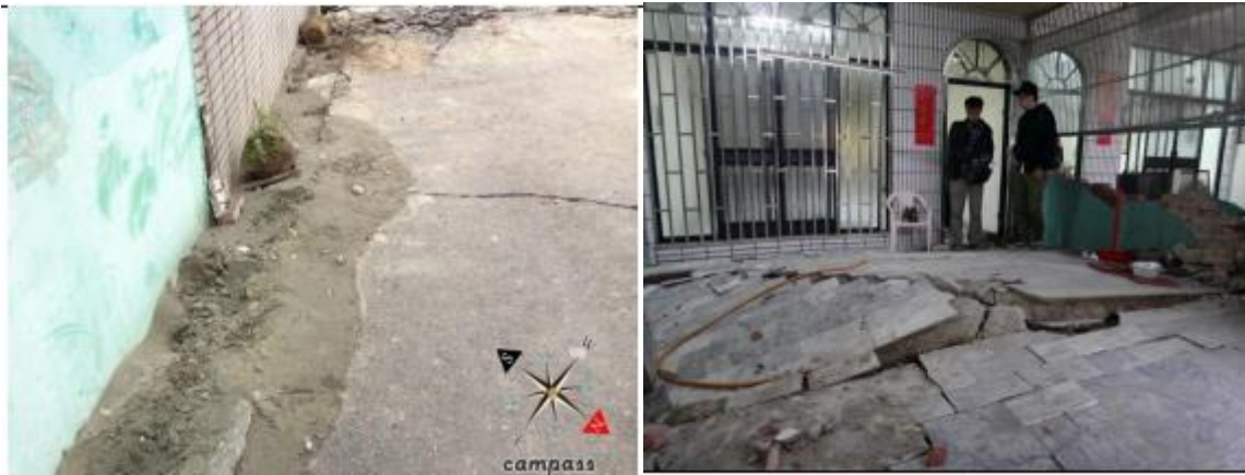
圖 2-2-8 0206 地震新市區三民街災損圖
